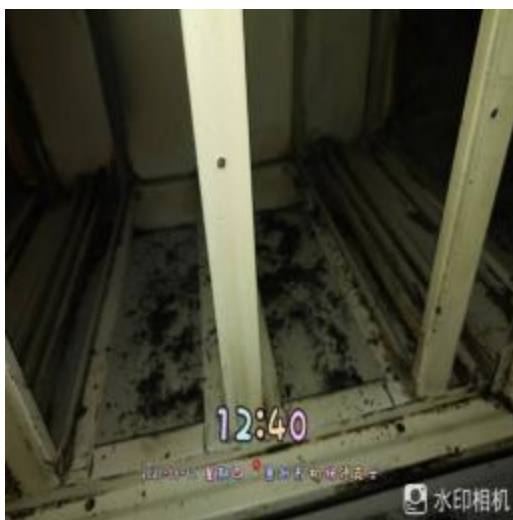
净化器机箱清洗前
