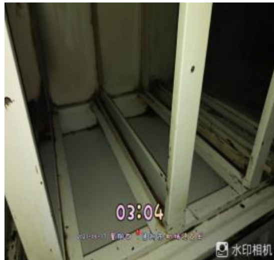
净化器机箱清洗后
