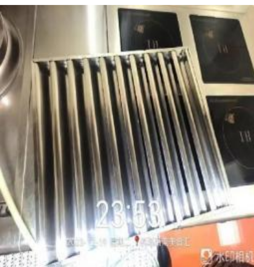
防火板清洗后
