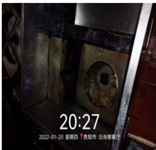
运水风扇清洗中
