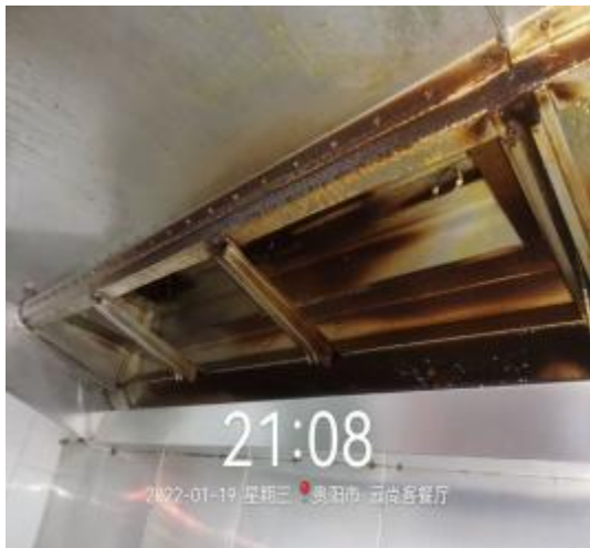
大厨房烟罩清洗前
