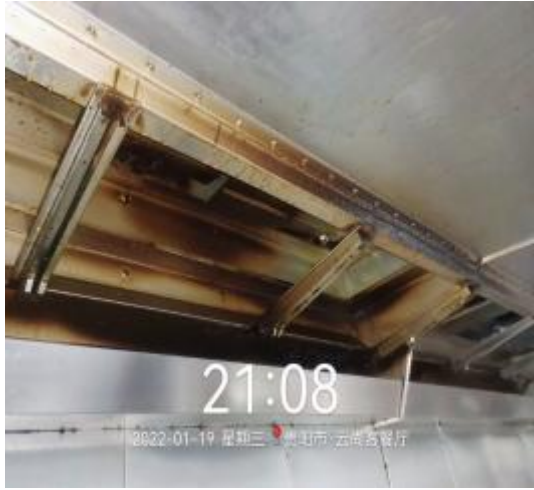
大厨房烟罩清洗前
