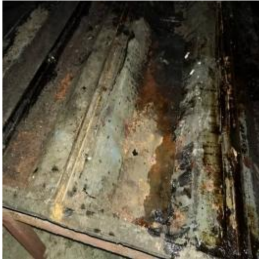
净化器机箱清洗前
