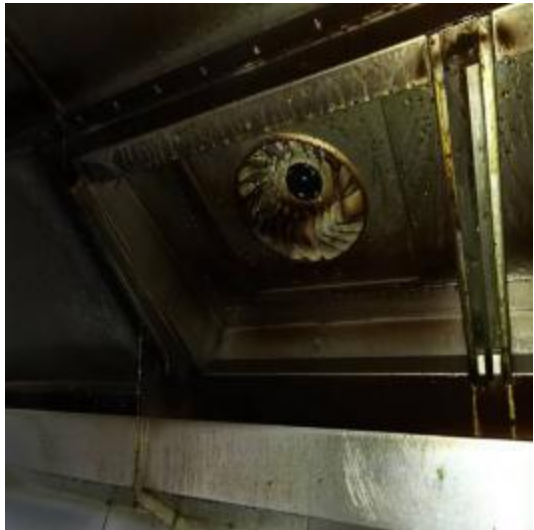
大厨房烟罩清洗前
