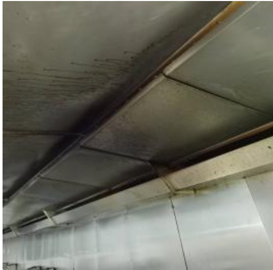
大厨房烟罩清洗前
