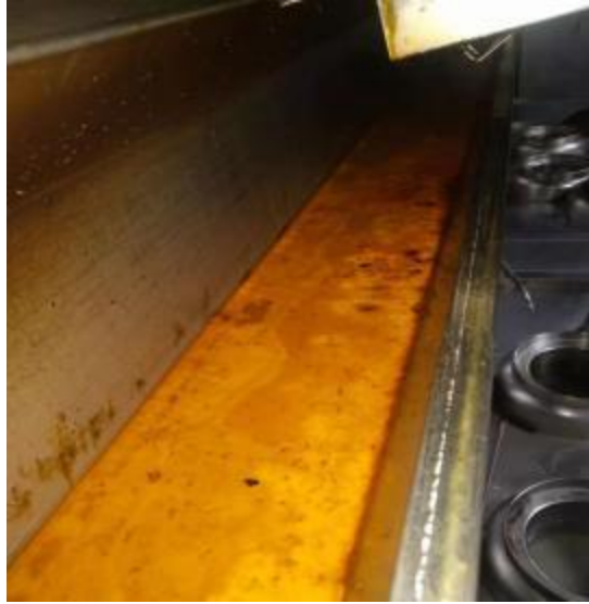
大厨房烟罩清洗前
