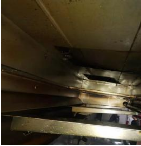
大厨房烟罩清洗前
