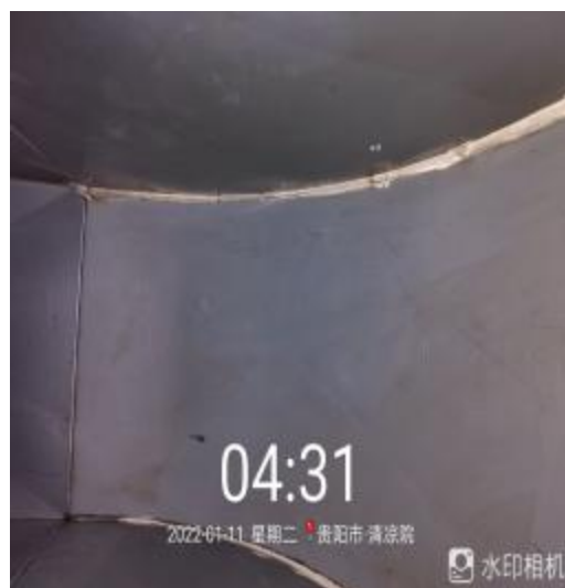
7号楼厨房净化器清洗后
