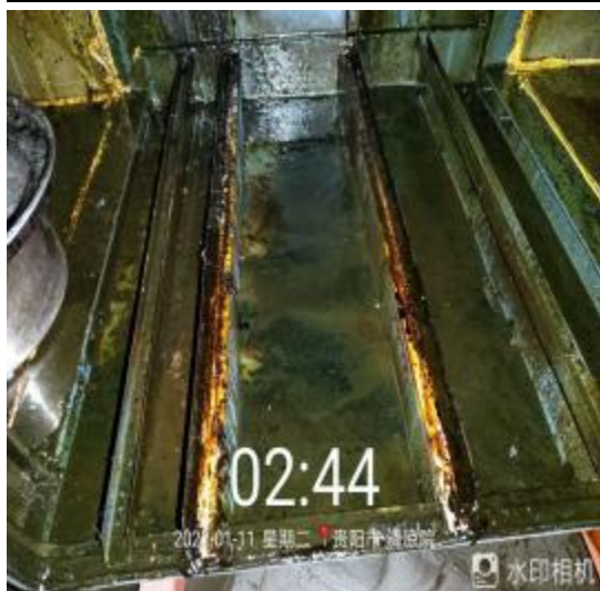
7号楼净化器机箱清洗前
