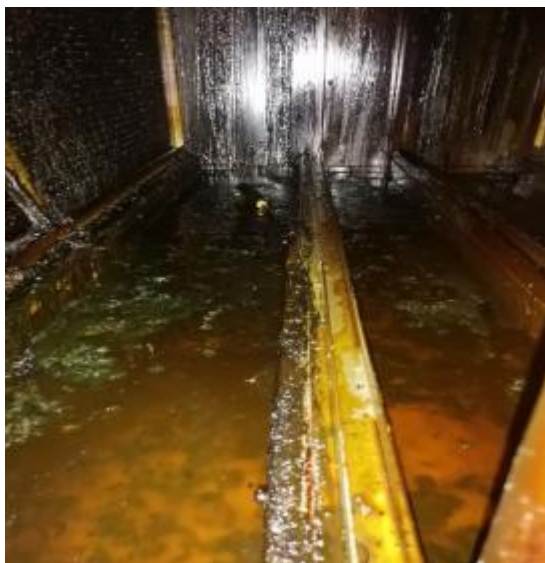
净化器机箱清洗前
