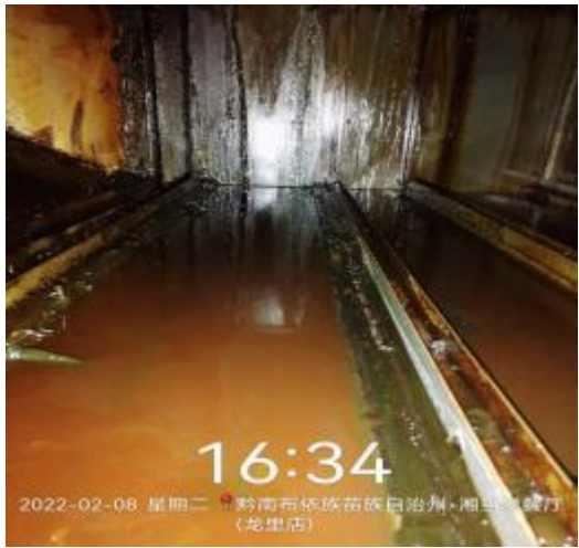
净化器机箱清洗前
