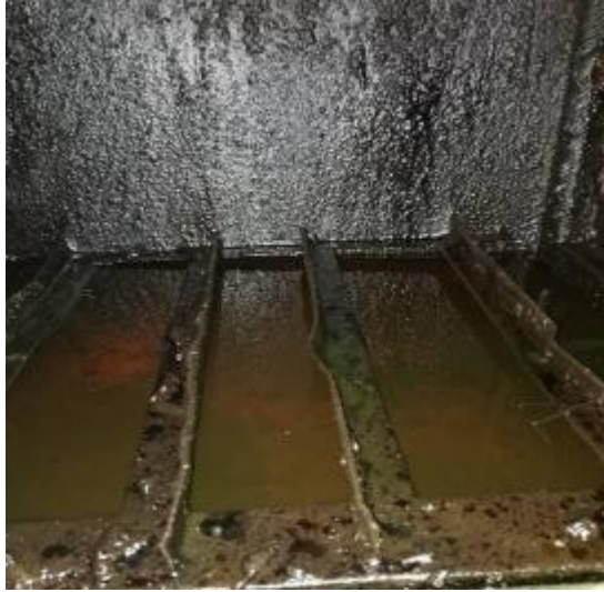
净化器机箱清洗前
