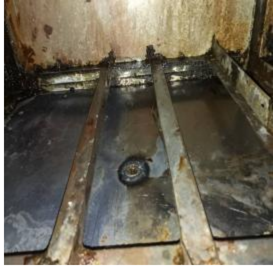
净化器机箱清洗后
