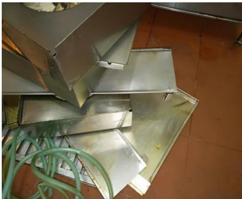
烧腊间风扇清洗前
