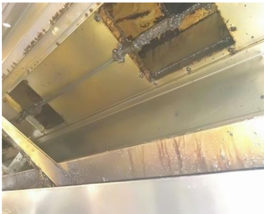
西厨房烟罩清洗前
