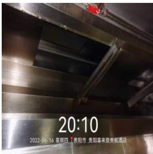
宴会厨房烟罩清洗前 1
