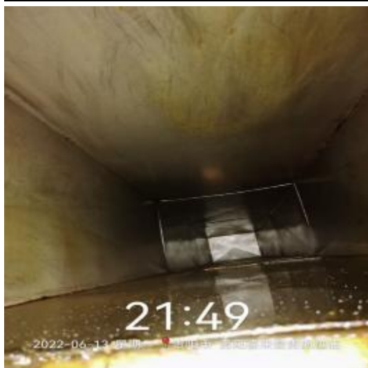
西厨房管道清洗前
