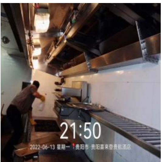
西厨房灶台烟罩清洗中
