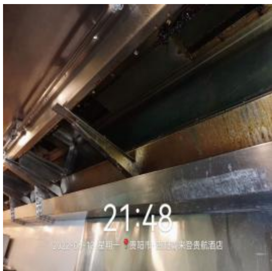
西厨房烟罩清洗前
