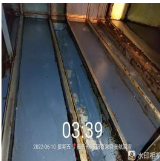
员工厨房净化器机箱清洗后
