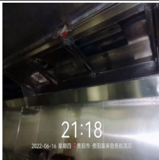
宴会厨房烟罩清洗后 2
