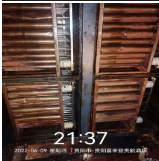
员工厨房净化器清洗前
