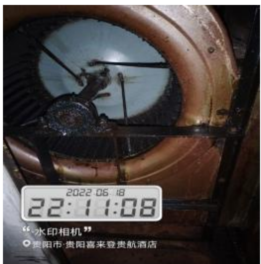
3楼平台风机清洗前 1
