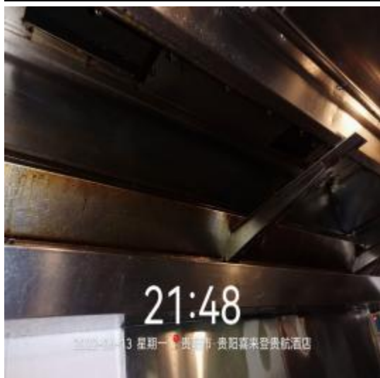
西厨房烟罩清洗前
