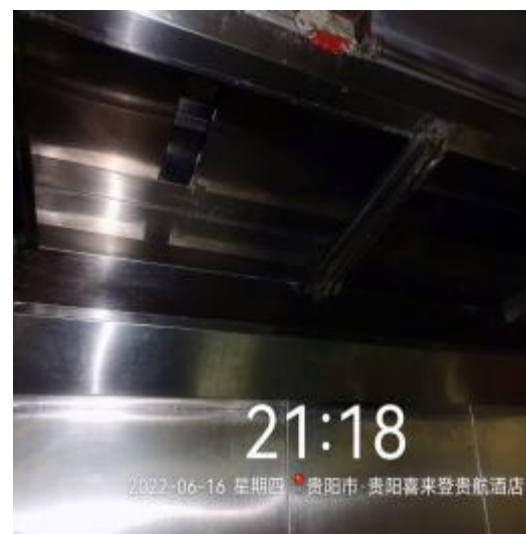
宴会厨房烟罩清洗后 1
