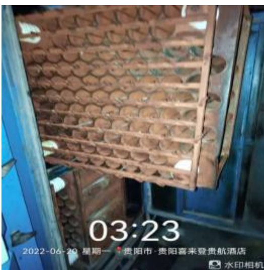
3楼平台净化器清洗后 1
