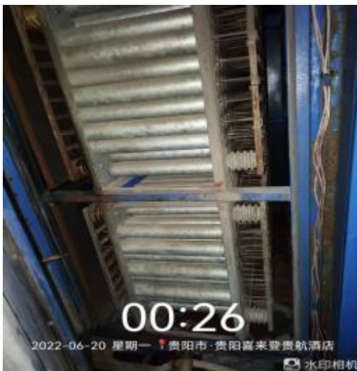
3楼平台净化器清洗后 2
