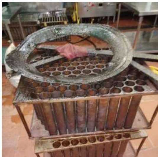
3楼平台净化器清洗中
