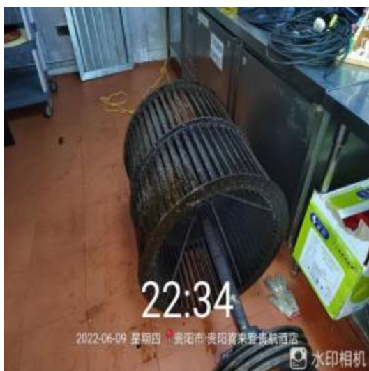
员工厨房风机清洗前
