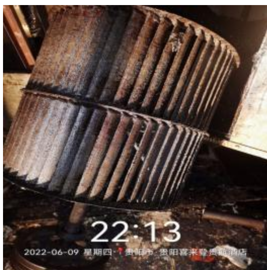
员工厨房风机清洗前
