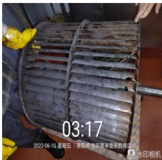
员工厨房风机清洗后
