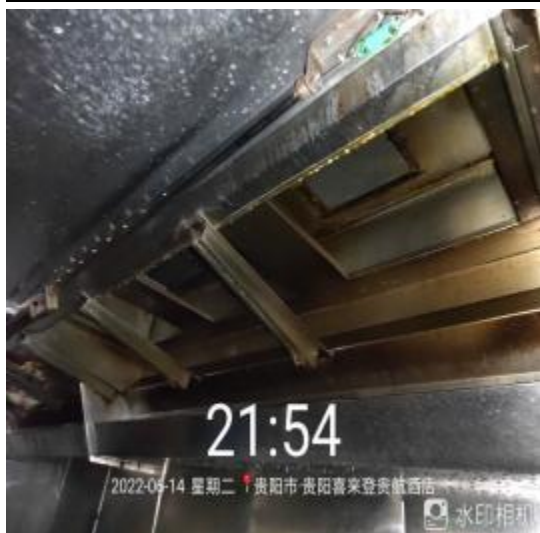
中厨房烟罩清洗前
