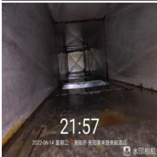
中厨房管道清洗前
