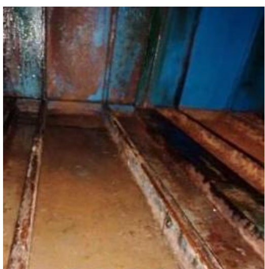
3楼平台净化器机箱清洗前
