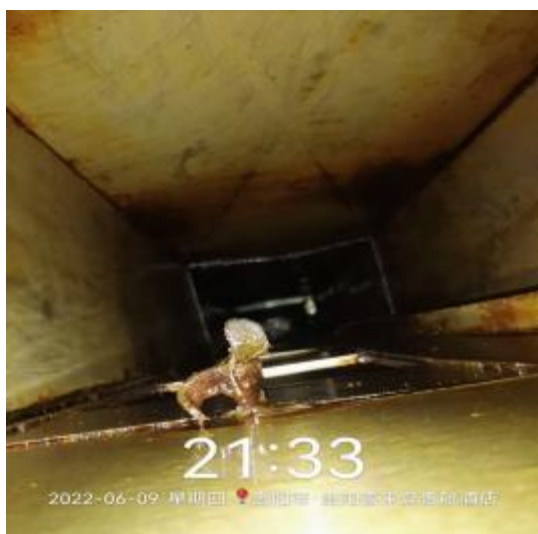
员工厨房管道清洗前
