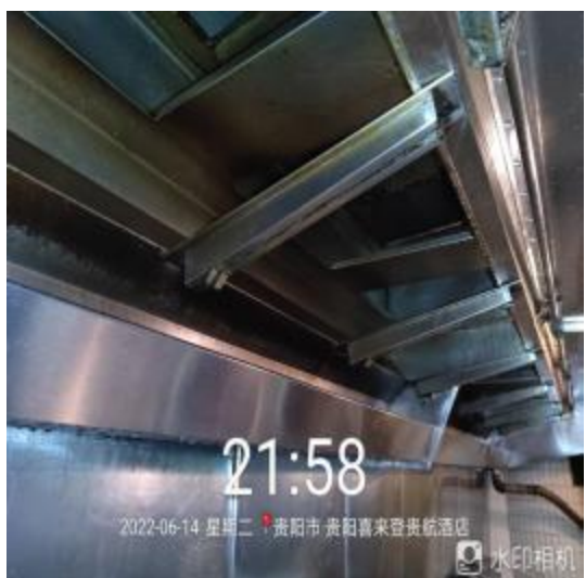
中厨房烟罩清洗前
