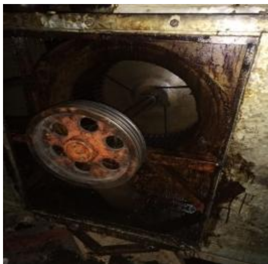
员工厨房风机清洗前
