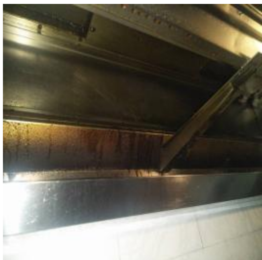
西厨房烟罩清洗前
