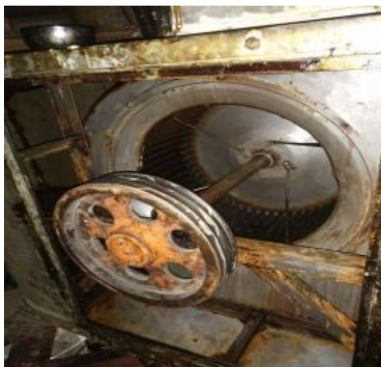
员工厨房风机清洗后
