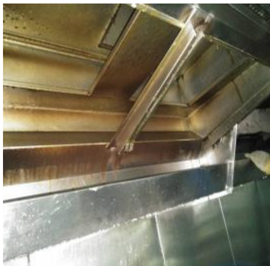
中厨房烟罩清洗前
