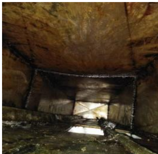
员工厨房管道清洗后
