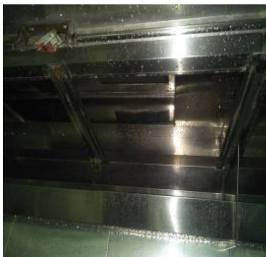
宴会厨房烟罩清洗后
