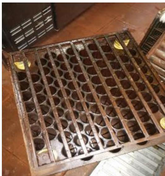
员工厨房净化器清洗前
