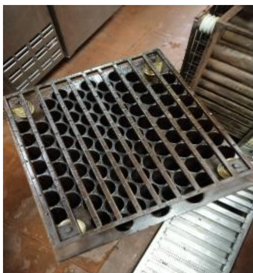
三楼净化器清洗前
