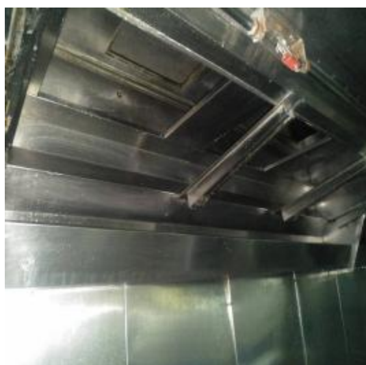
中厨房烟罩清洗后
