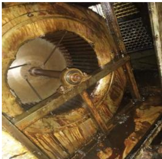
三楼平台风机清洗前 1
