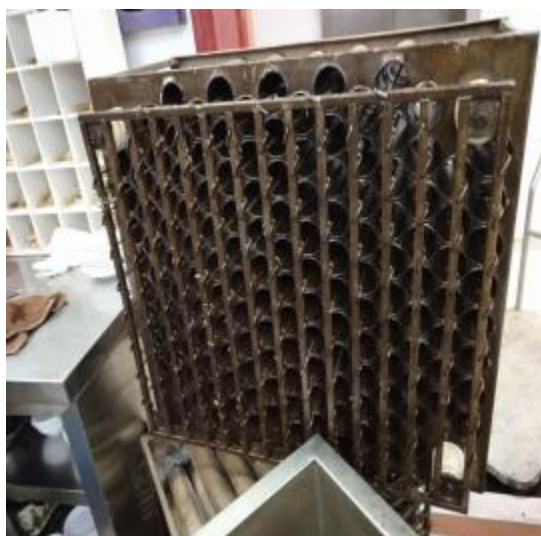
三楼净化器清洗后
