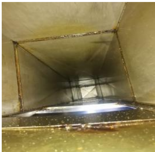
中厨房管道清洗前
