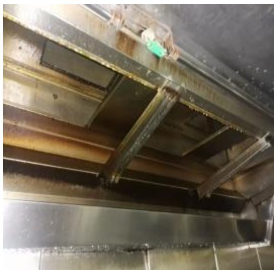
中厨房烟罩清洗前
