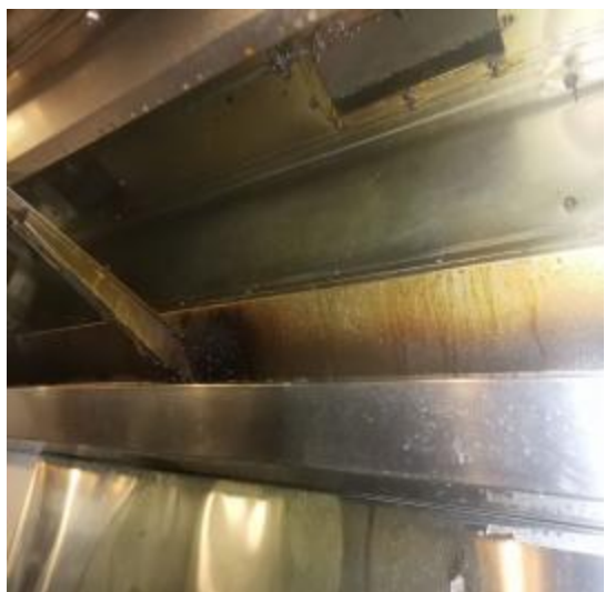
西厨房烟罩清洗前
