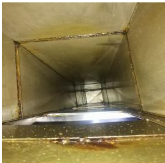
宴会厨房管道清洗前
