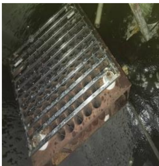
3楼平台净化器清洗后 2
