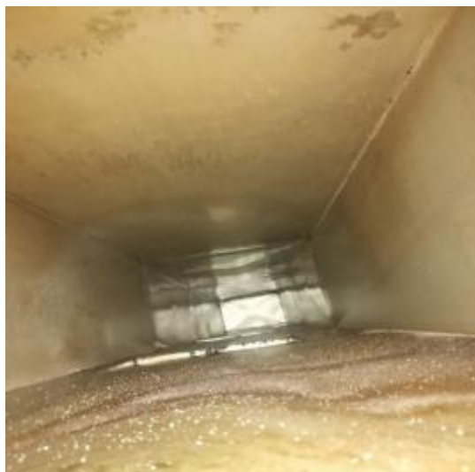
西厨房管道清洗前
