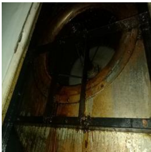
3 楼平台风机清洗前 1
