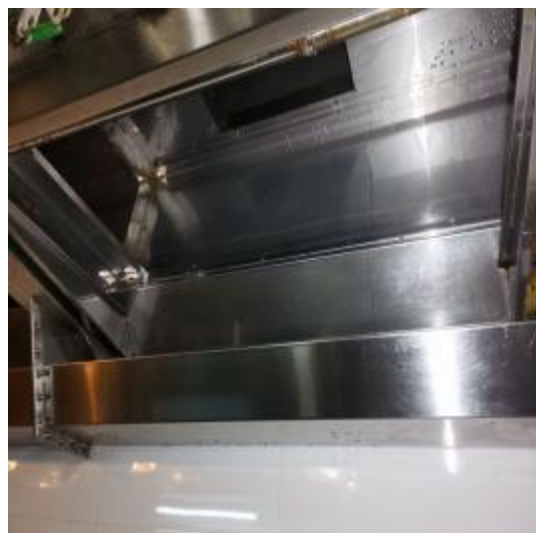
宴会厨房烟罩清洗后 1
