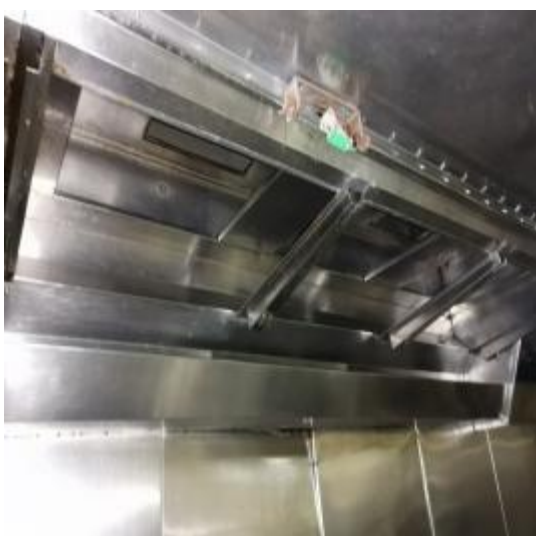
宴会厨房烟罩清洗前 2
