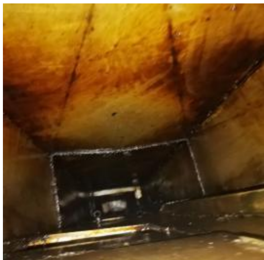
员工厨房管道清洗前
