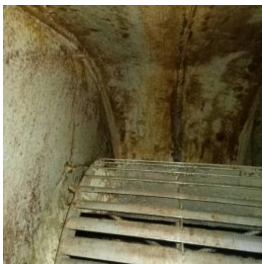
3 楼平台风机清洗前 2
