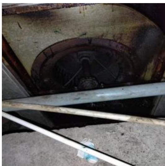
2 楼明档风机清洗前
