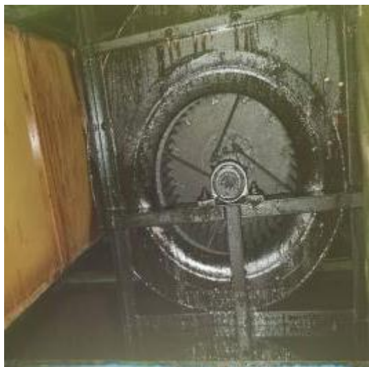
3楼平台风机清洗前 3
