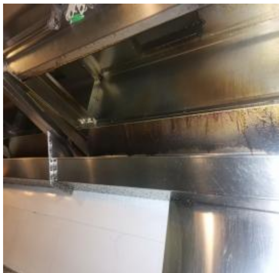
西厨房烟罩清洗前
