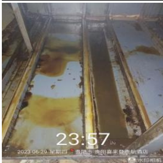
员工厨房净化器清洗前
