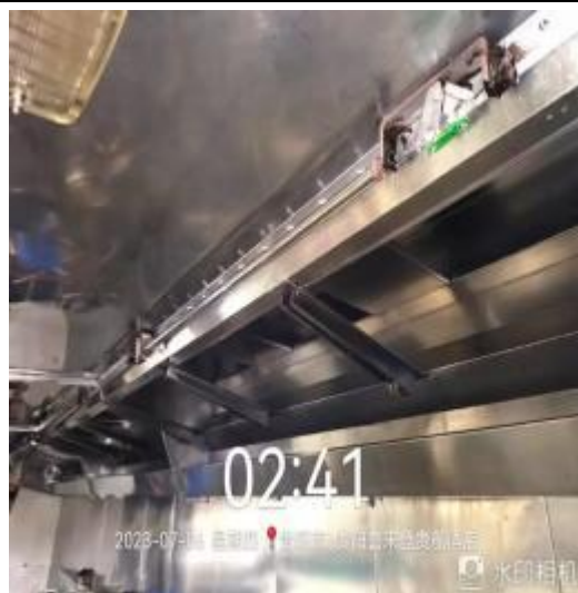
中厨房烟罩清洗后
