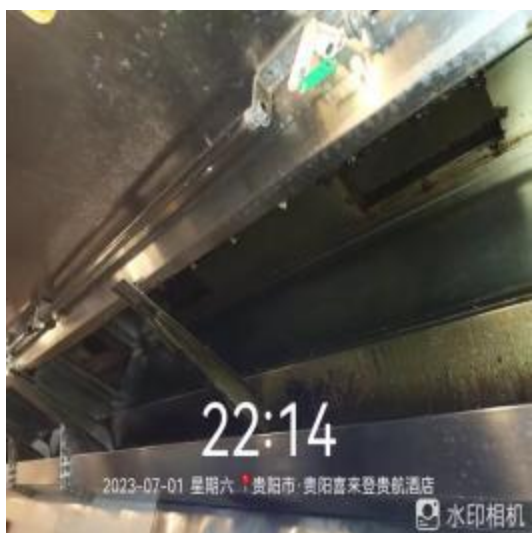
西厨房烟罩清洗前
