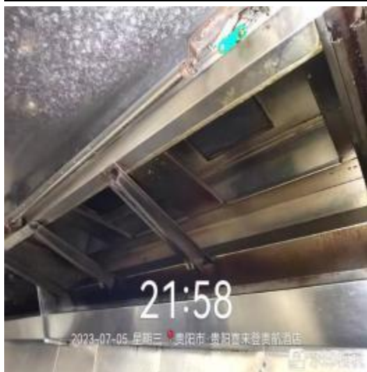
中厨房烟罩清洗前
