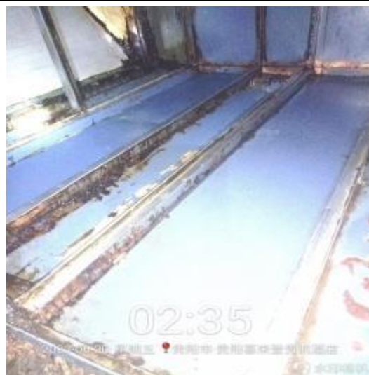
员工厨房净化器清洗后
