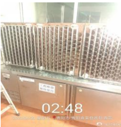
员工厨房净化器清洗后
