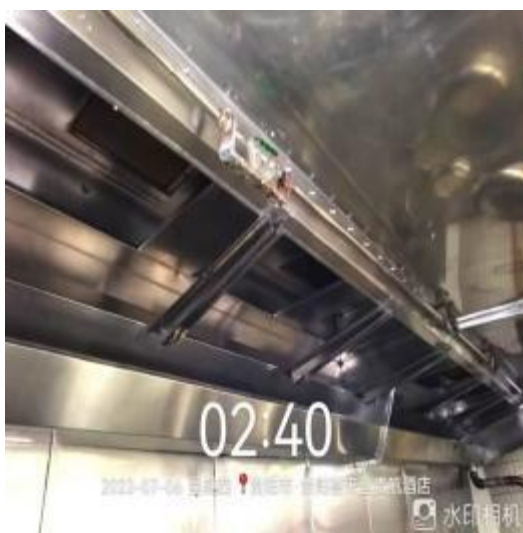
中厨房烟罩清洗后
