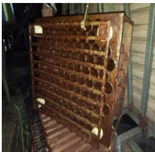
3楼平台净化器清洗前 1
