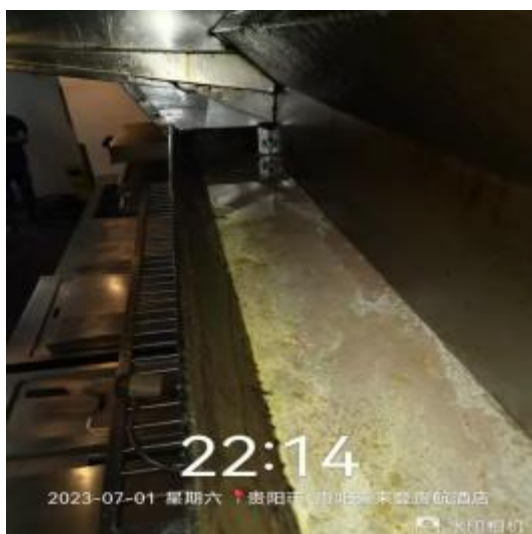
西厨房烟罩清洗前
