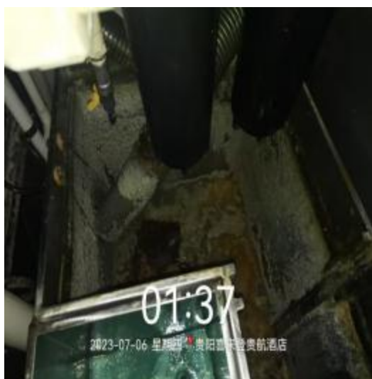
运水控制箱清洗前
