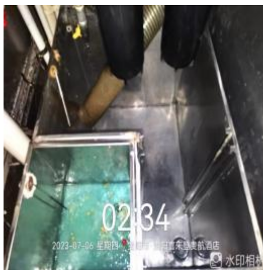
运水控制箱清洗后
