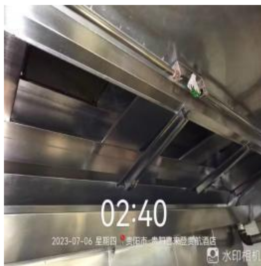
中厨房烟罩清洗后
