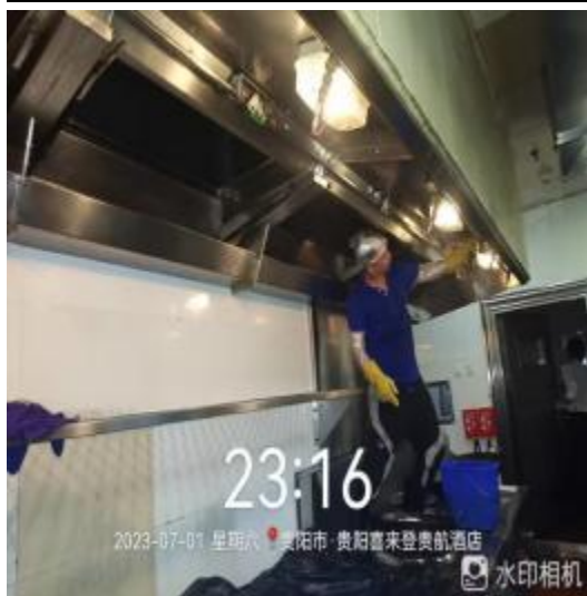
西厨房烟罩清洗中
