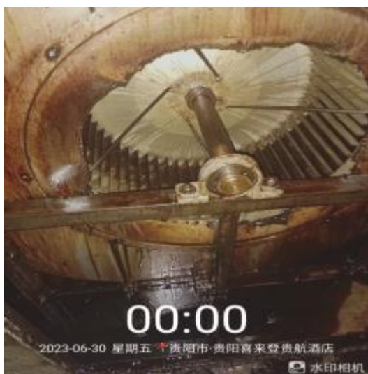
员工厨房风机清洗前
