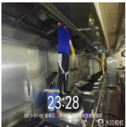
中厨房烟罩清洗前
