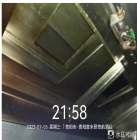
中厨房烟罩清洗前
