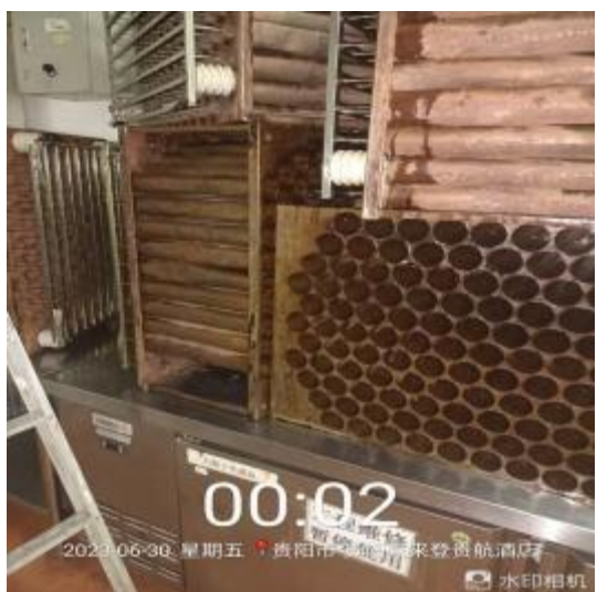
员工厨房净化器清洗前
