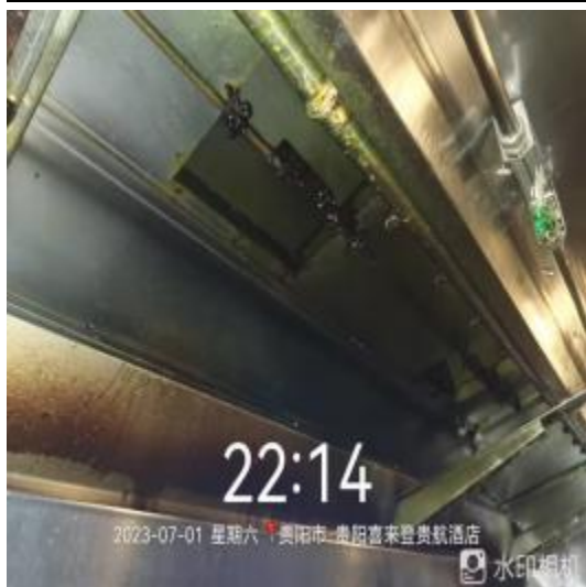
西厨房烟罩清洗前
