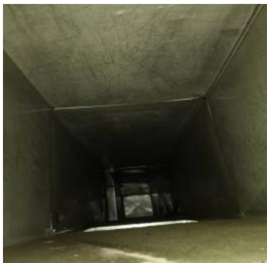
烧腊房管道清洗前
