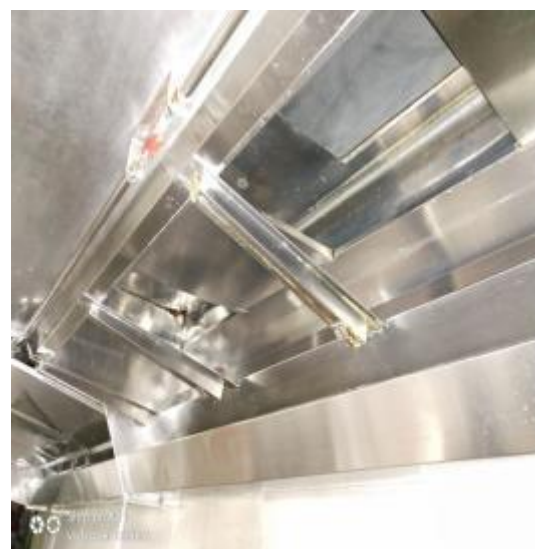
宴会厨房烟罩清洗后
