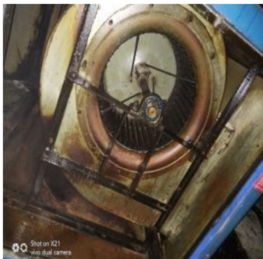
3楼平台风机清洗前 5
