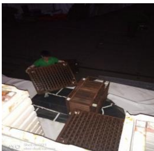
3楼平台净化器清洗前
