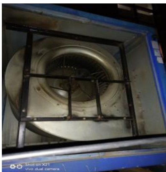
3楼平台风机清洗前 4
