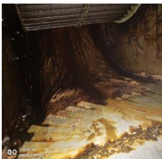
3楼平台风机清洗前 7
