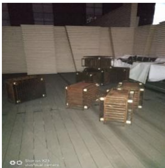
3楼平台净化器清洗前
