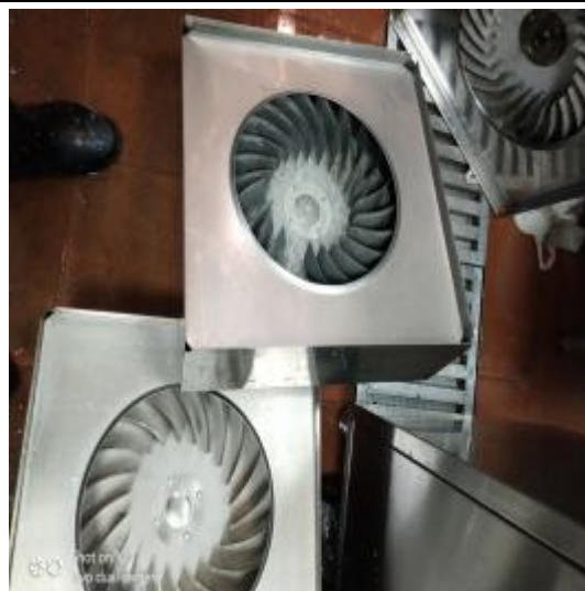
38楼风扇清洗后
