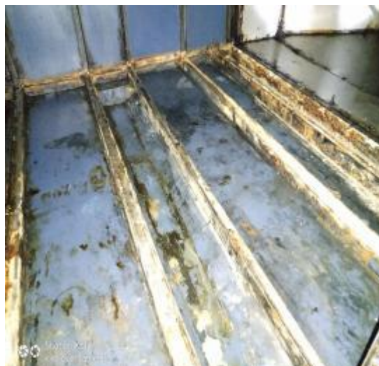
3楼平台净化器内部清洗后
