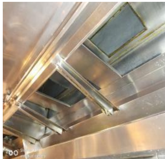
中厨房烟罩清洗后
