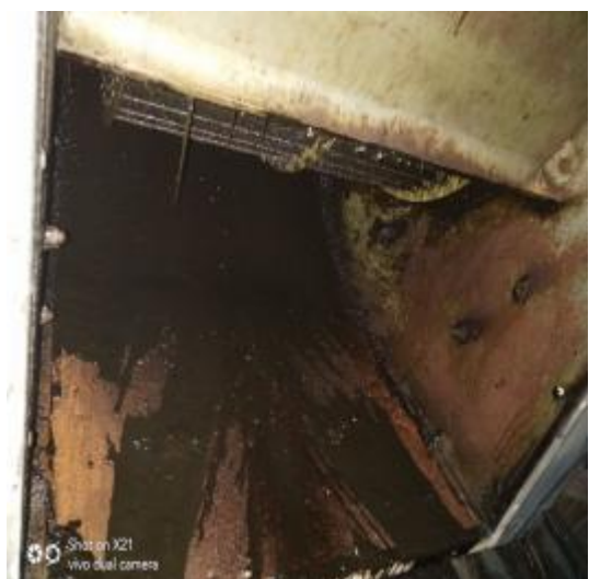
3楼平台风机清洗前 6
