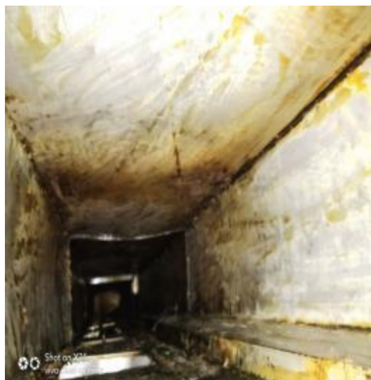
员工厨房管道清洗后
