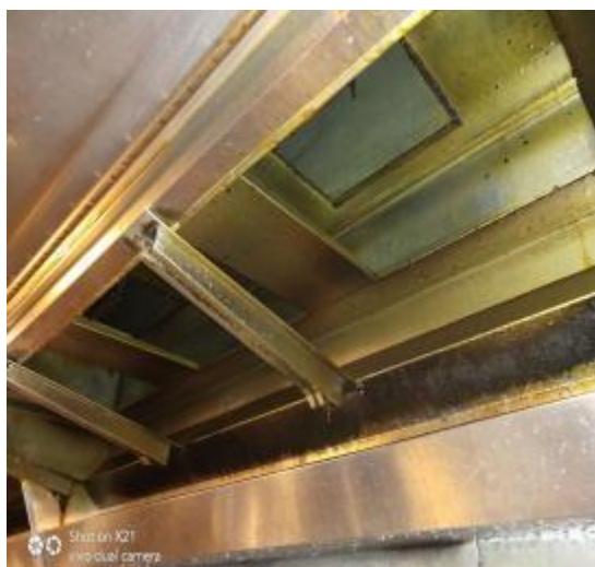
中厨房烟罩清洗前
