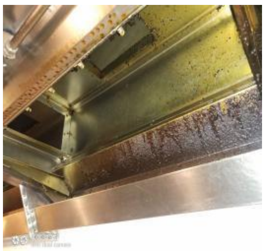
西厨房烟罩清洗前
