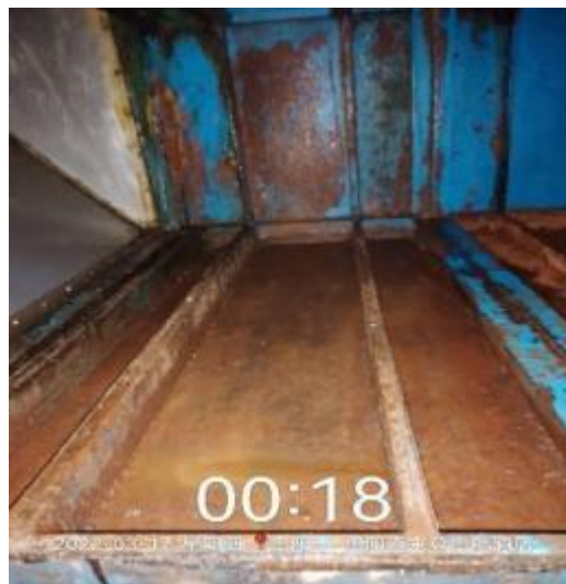
净化器机箱清洗后
