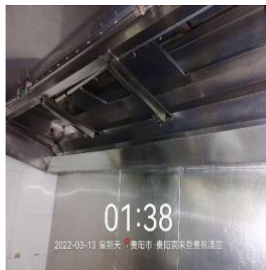
中厨房烟罩清洗后
