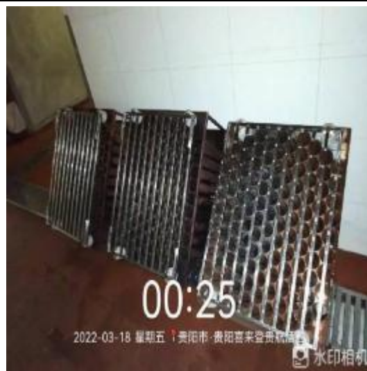
员工厨房净化器清洗后
