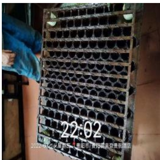
3楼平台净化器清洗前1
