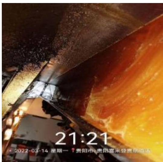
西厨房烟罩清洗前
