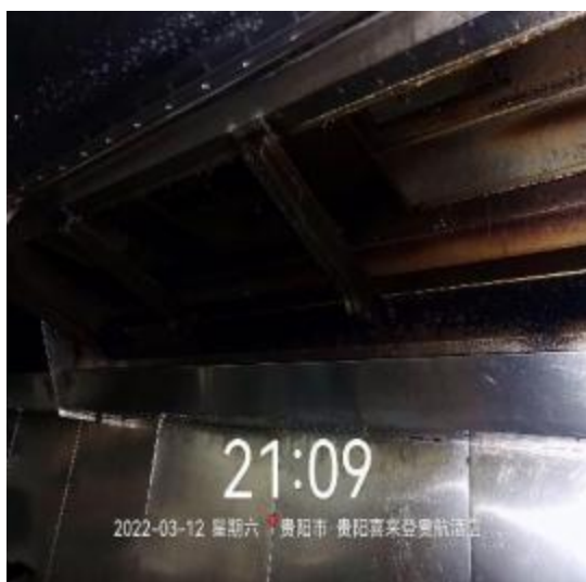
中厨房烟罩清洗前
