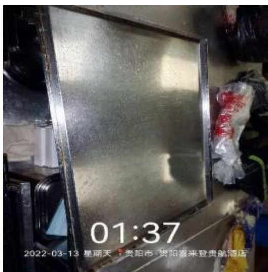
中厨房防火板清洗后
