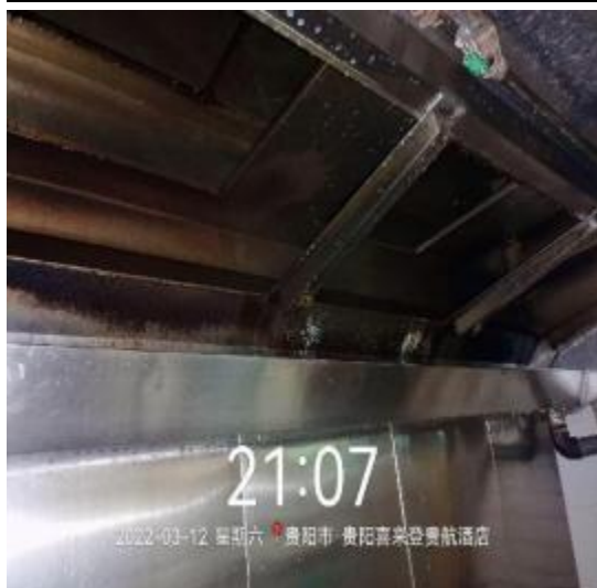
中厨房烟罩清洗前
