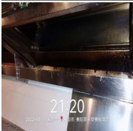
西厨房烟罩清洗前
