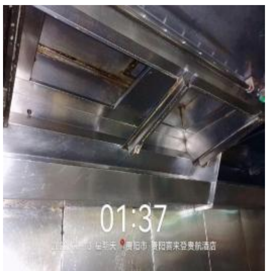
中厨房烟罩清洗后
