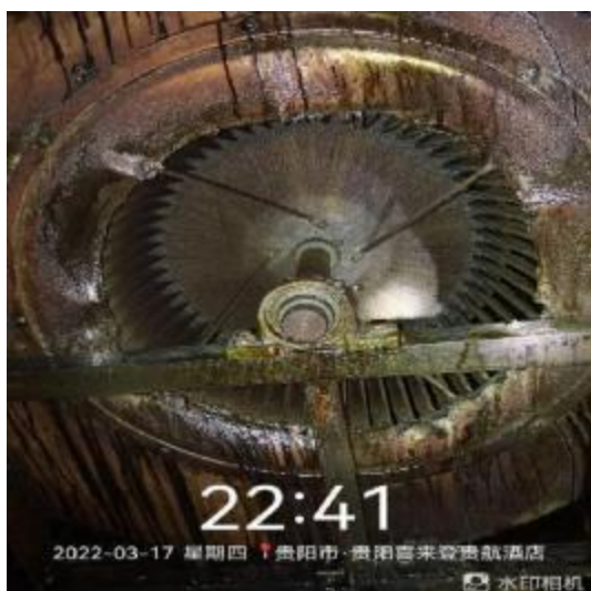
员工厨房风机清洗前
