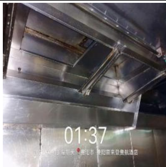
中厨房烟罩清洗后
