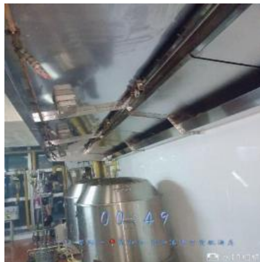
烧腊房烟罩整体清洗后
