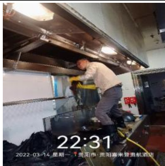
西厨房灶台烟罩清洗后
