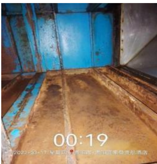
净化器机箱清洗后
