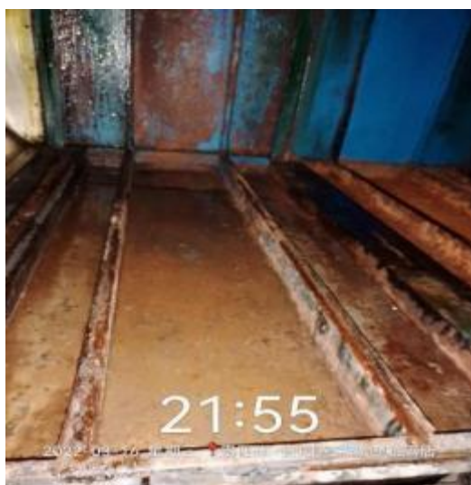
净化器机箱清洗前
