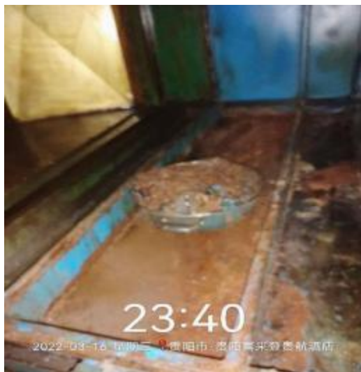
净化器机箱清洗前
