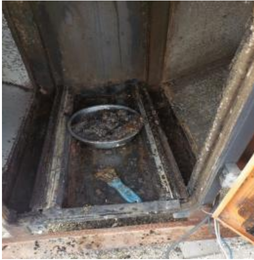
净化器机箱清洗前
