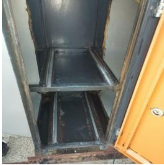
净化器机箱清洗后
