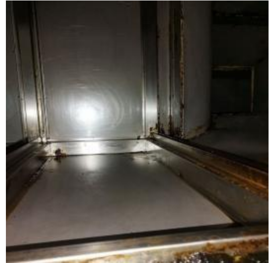
净化器机箱清洗后
