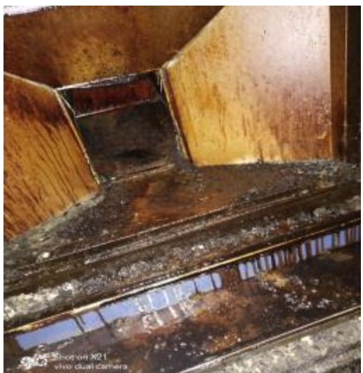
净化器机箱清洗前
