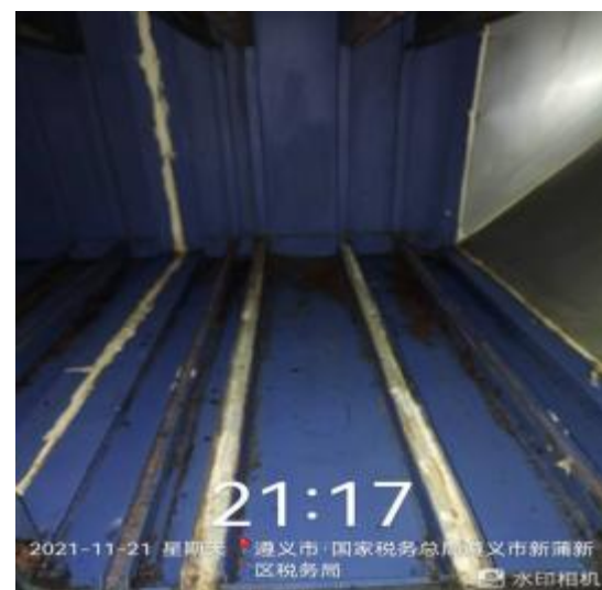
净化器机箱清洗后
