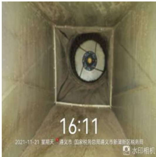
管道风机清洗前
