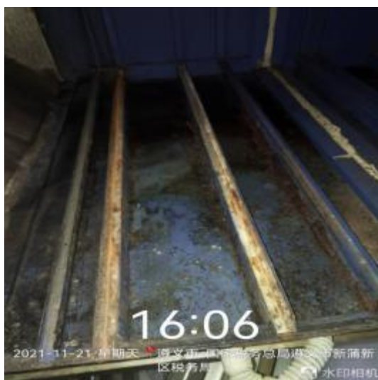
净化器机箱清洗前
