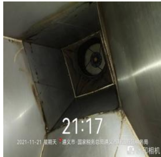
管道风机清洗后
