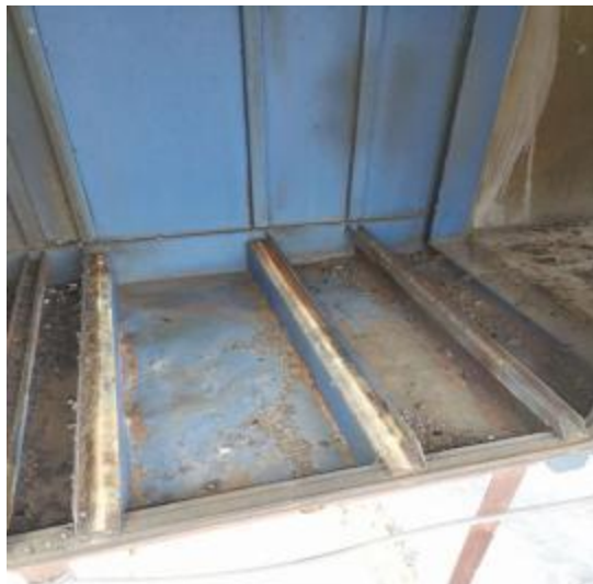
净化器机箱清洗前
