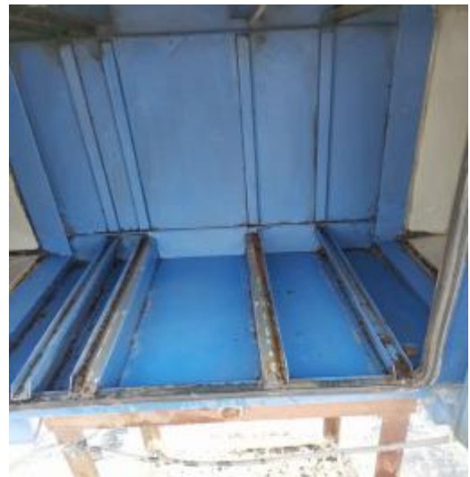
净化器机箱清洗后
