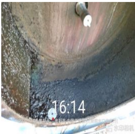
风机机箱清洗前
