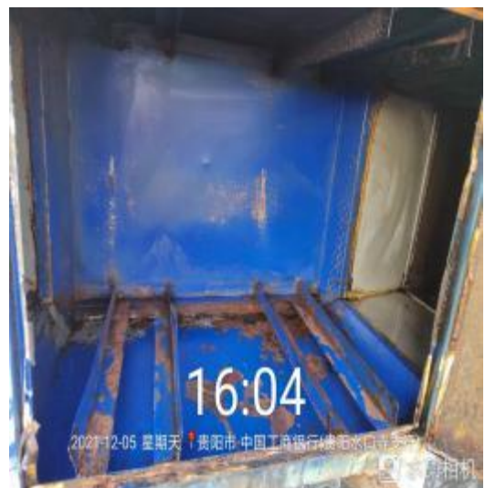
净化器机箱清洗后
