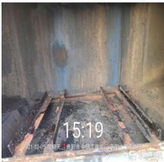
净化器机箱清洗前
