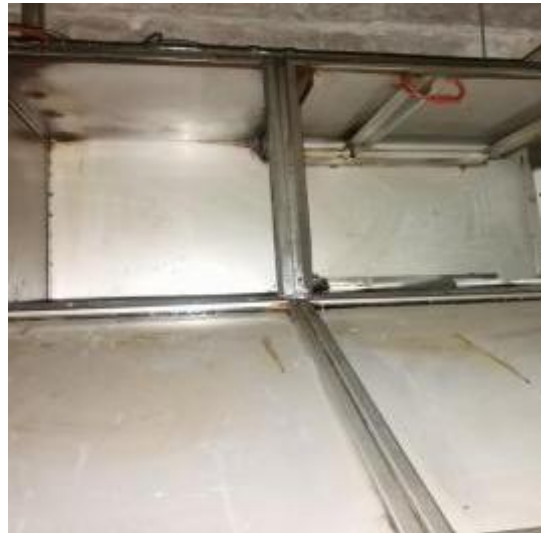
净化器机箱清洗后
