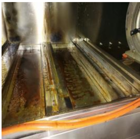
净化器机箱清洗前
