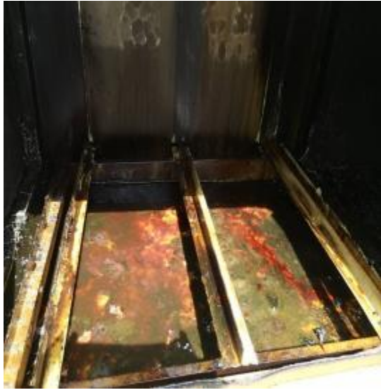
净化器机箱清洗前
