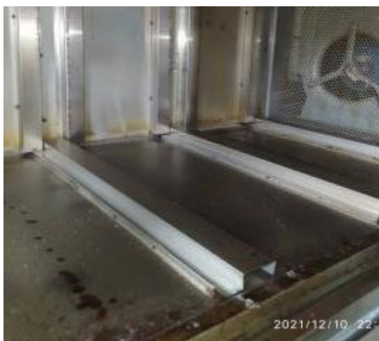
净化器机箱清洗前
