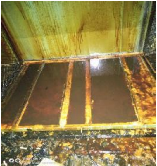
净化器机箱清洗前
