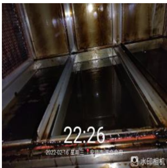
净化器机箱清洗前
