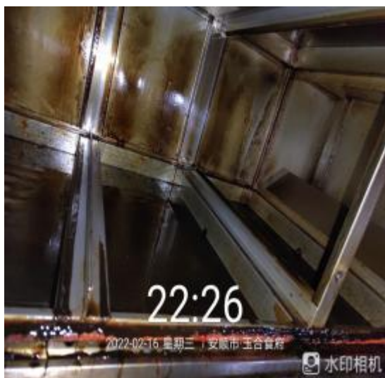
净化器机箱清洗前
