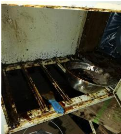
净化器内部清洗前
