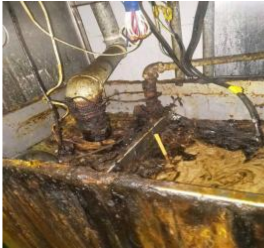
运水烟罩控制箱清洗前 1
