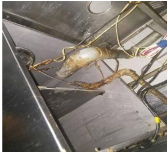
运水烟罩控制箱清洗后 1
