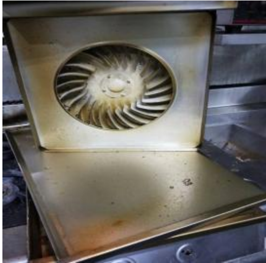
排风扇清洗前
