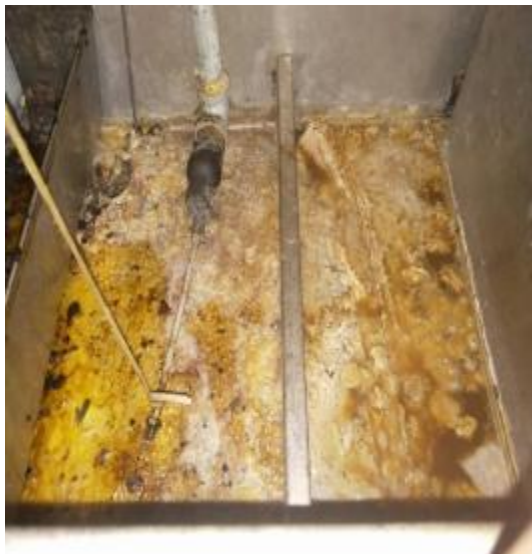
运水烟罩控制箱清洗前 2
