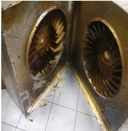
排风扇清洗前
