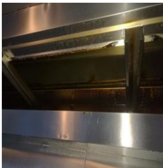
中厨房烟罩清洗前
