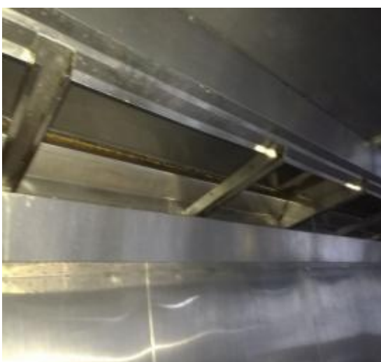
中厨房烟罩清洗后 2
