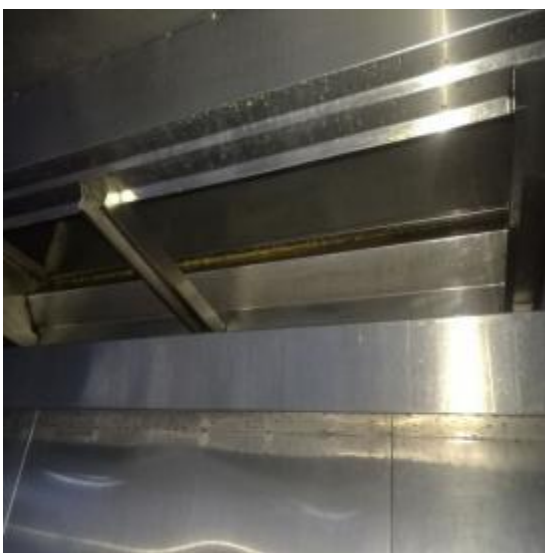
中厨房烟罩清洗后
