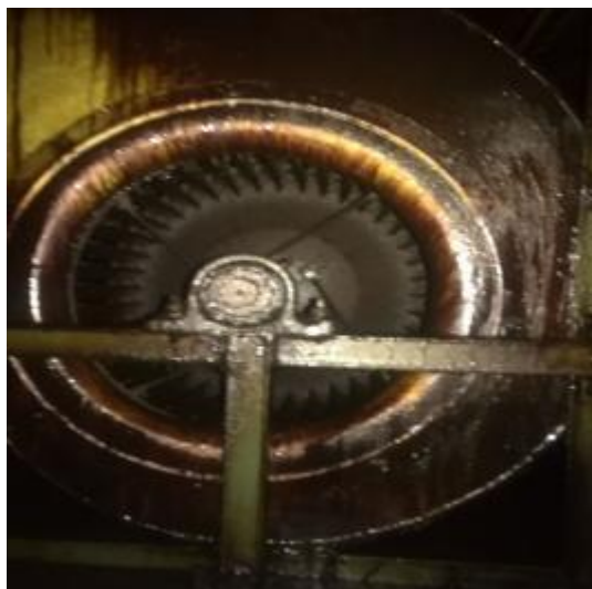
西厨房风机清洗前
