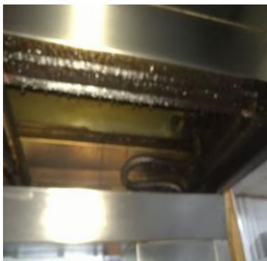
西厨房烟罩清洗前 2
