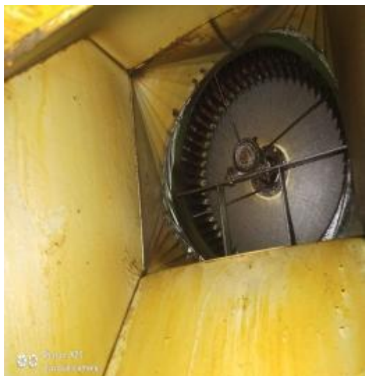
中厨房风机清洗前 1
