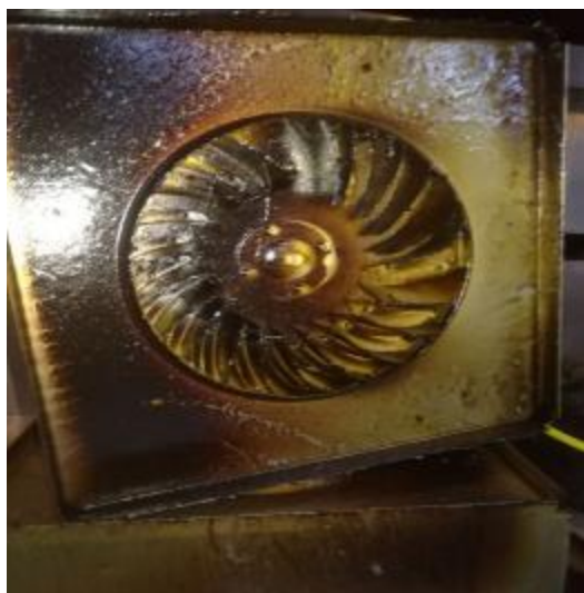
中厨房风扇清洗前
