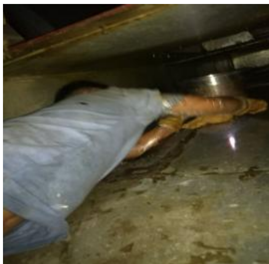
川菜厨房管道清洗前
