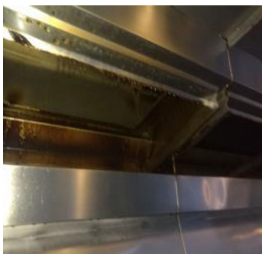
中厨房烟罩清洗前 2
