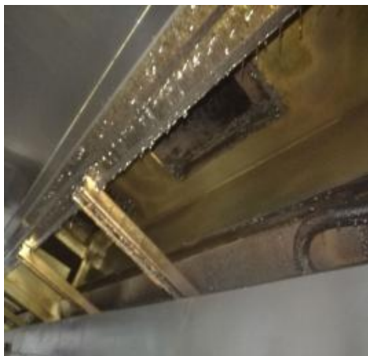
西厨房烟罩清洗前 1
