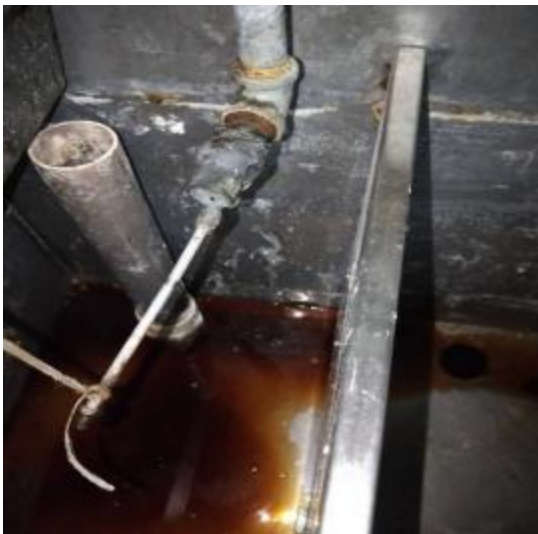
运水控制箱清洗前
