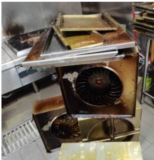
排风扇清洗前
