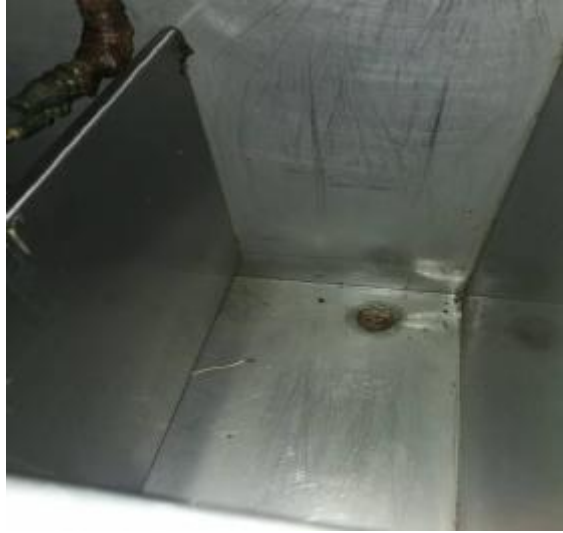
运水控制箱清洗前 1
