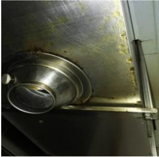
新风管清洗前
