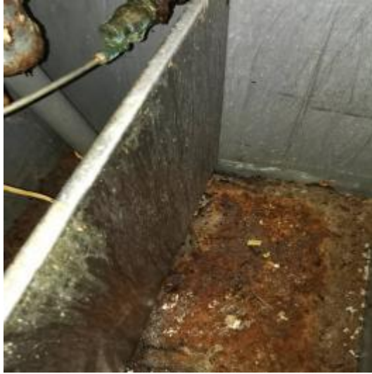
运水控制箱清洗前 1
