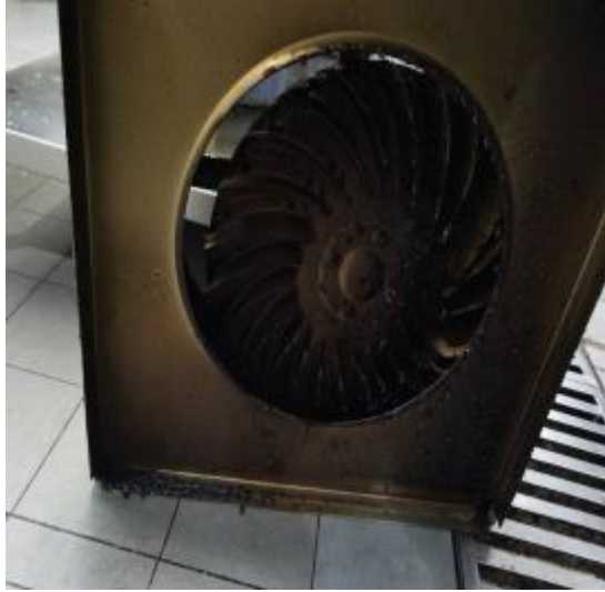
排风扇清洗前 2
