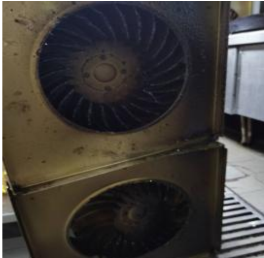
排风扇清洗前
