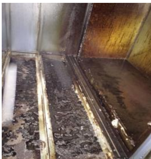
净化器内部清洗前
