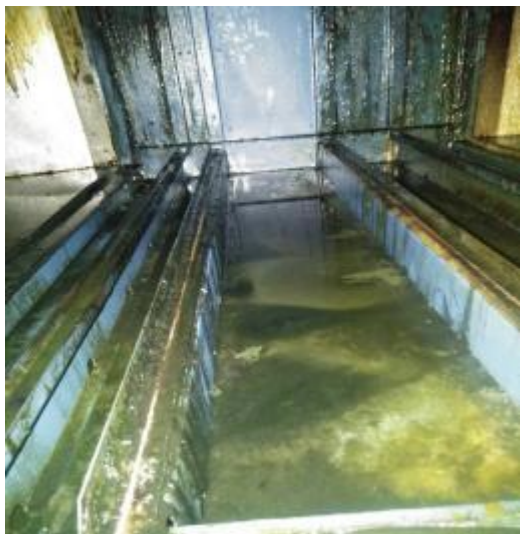
净化器内部清洗前
