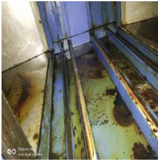
净化器内部清洗前
