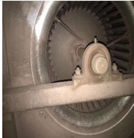
西厨房风机清洗前
