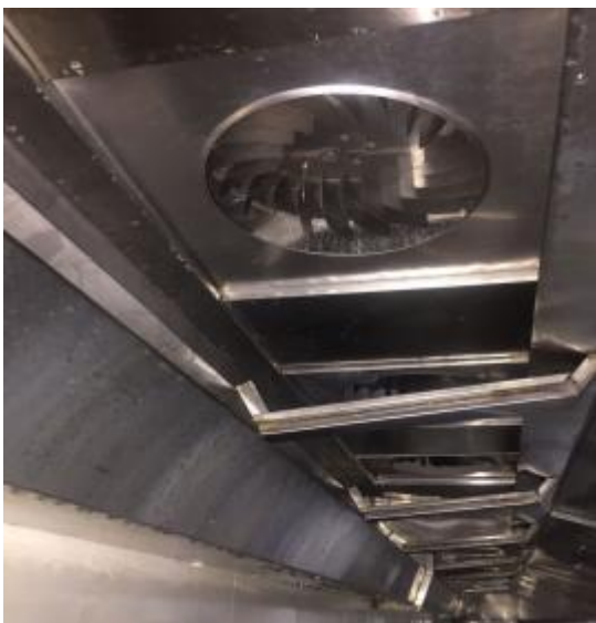
中厨房烟罩清洗后
