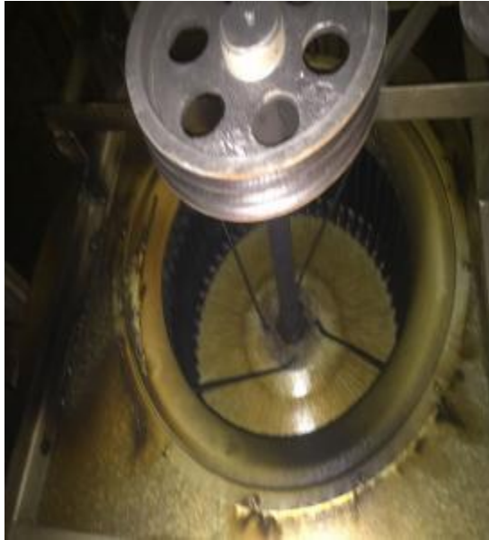
员工厨房风机清洗前
