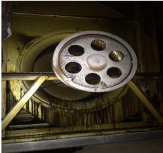
中厨房风机清洗前
