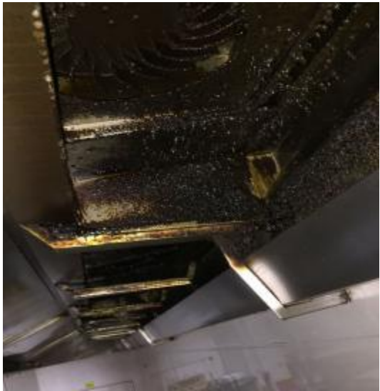
中厨房烟罩清洗前
