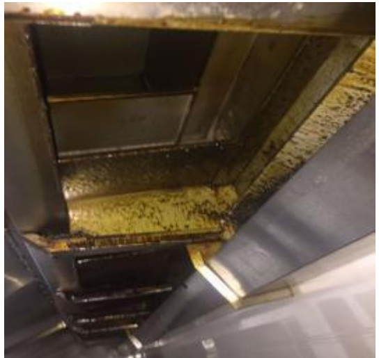
西厨房烟罩清洗前
