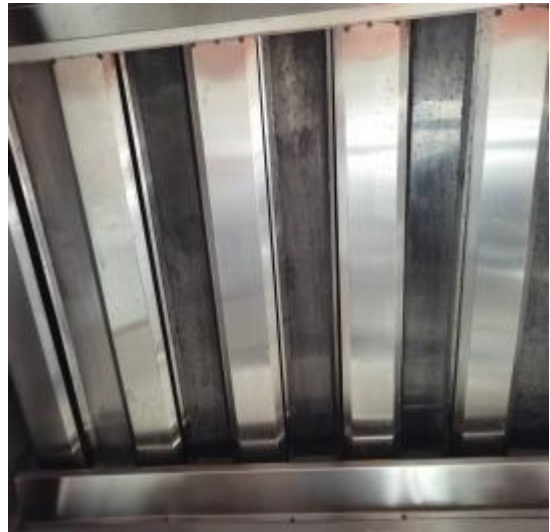
防火板清洗后
