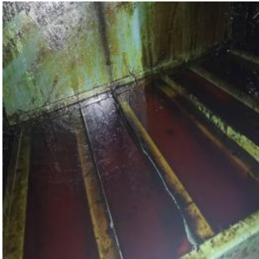
管道外观清洗前
