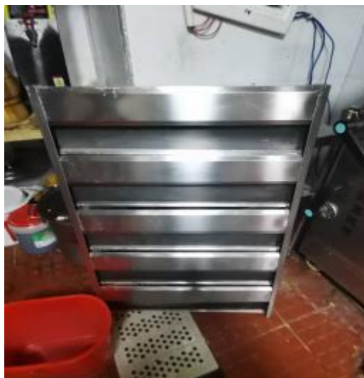
防火板清洗后
