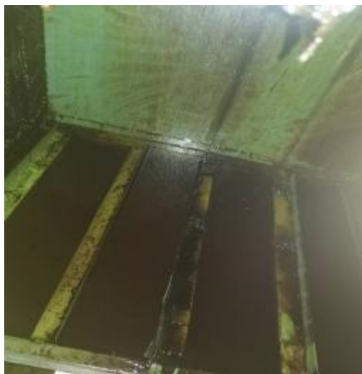
净化器机箱清洗前
