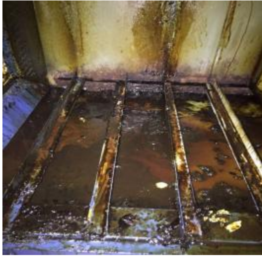
净化器内部清洗前
