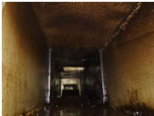
烤鸭管道清洗前
