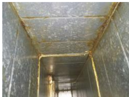
玛法小镇管道清洗后
