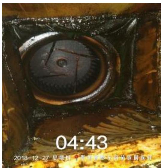
彭厨风机清洗前
