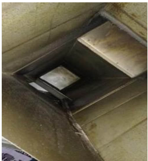
鼎云轩管道清洗前
