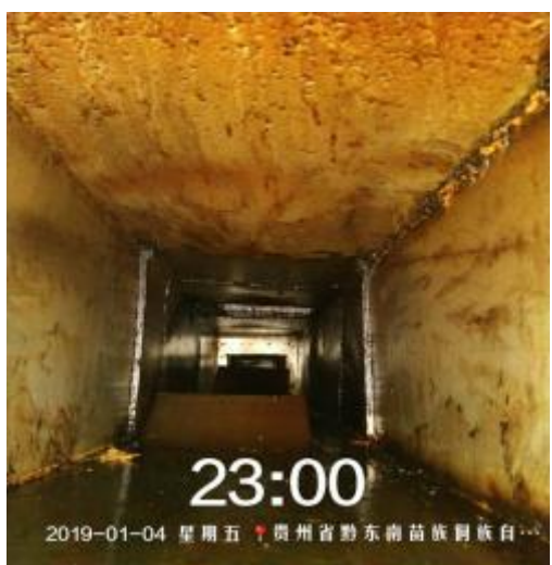
沅鼎阁管道清洗前
