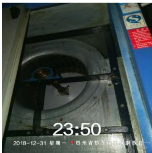
米辣原麻辣香锅风机清洗前
