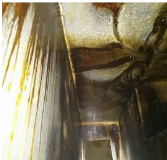
米辣原麻辣香锅管道清洗前
