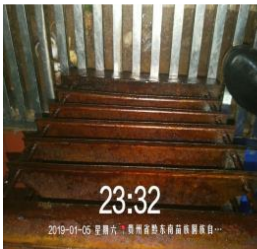
加州一号净化器清洗前
