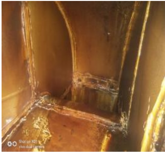
出风口管道清洗前 1
