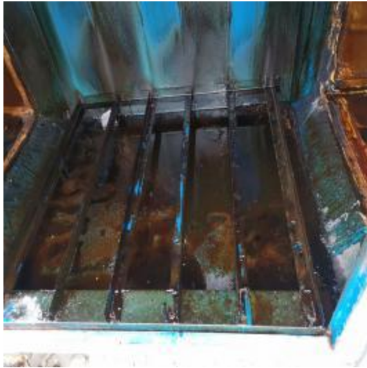
净化器机箱清洗前
