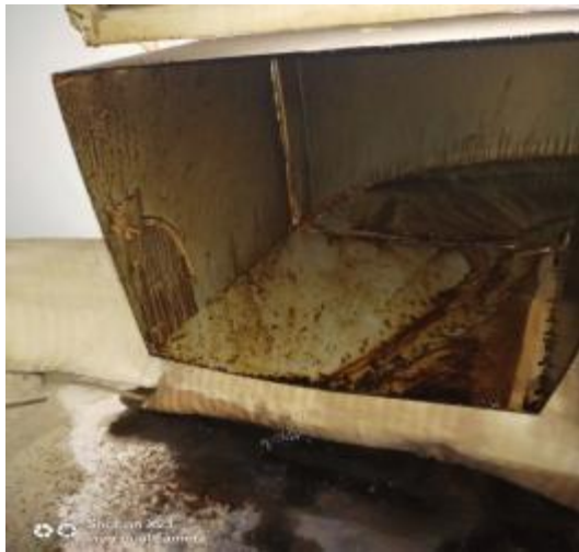
出风口管道清洗前 2
