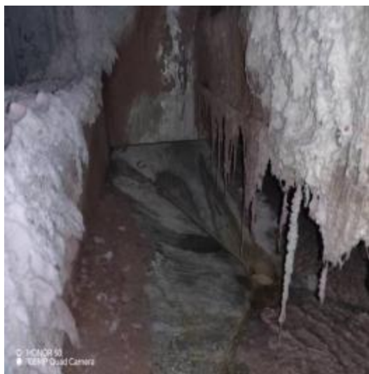
洗衣房管道清洗前
