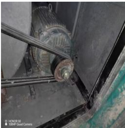
洗衣房风机清洗后
