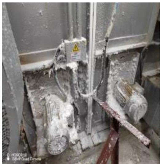
洗衣房风机清洗前
