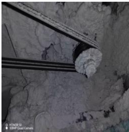
洗衣房风机清洗前
