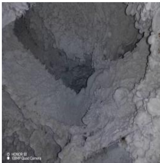
洗衣房管道清洗前
