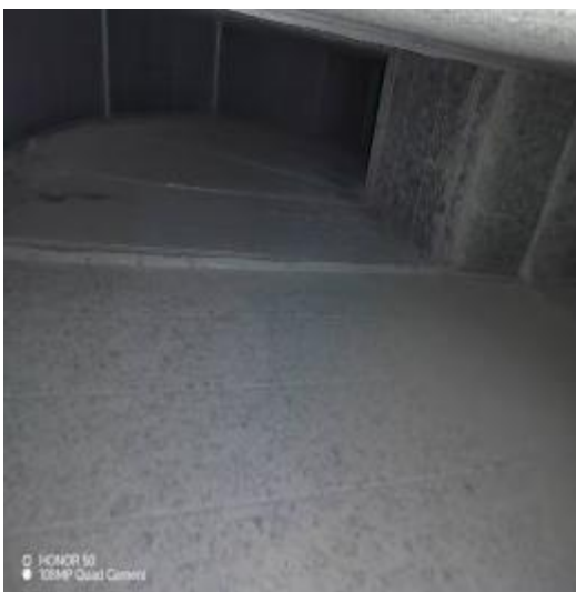
洗衣房管道清洗后
