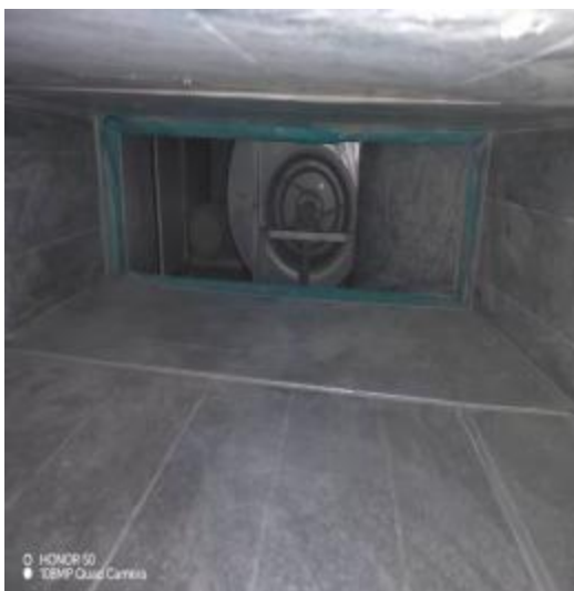
洗衣房风机清洗后
