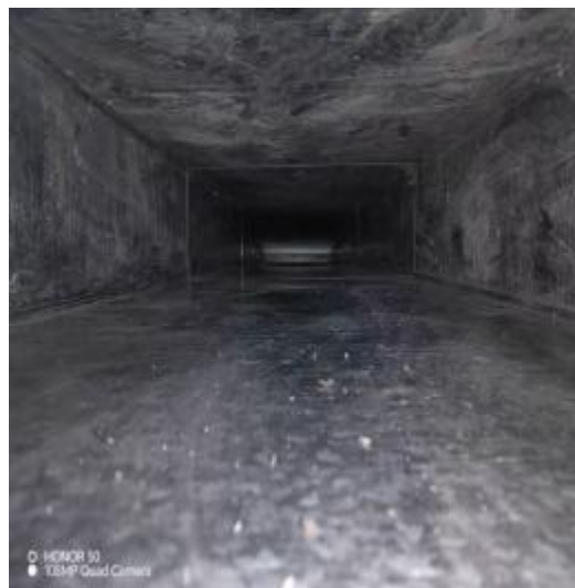
洗衣房管道清洗后
