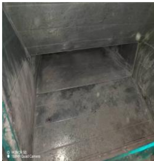
洗衣房管道清洗后
