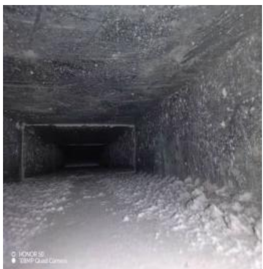
洗衣房管道清洗前
