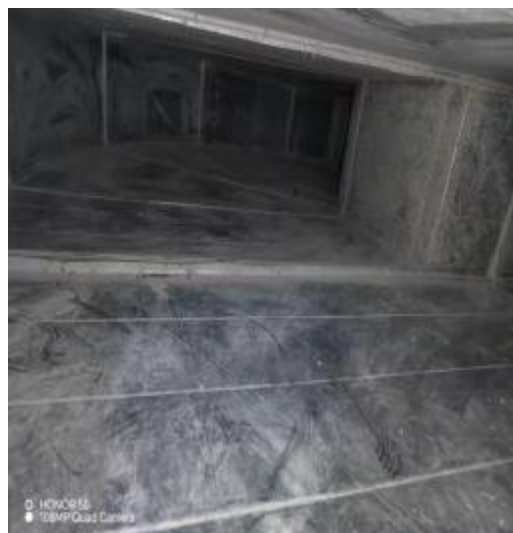
洗衣房管道清洗后
