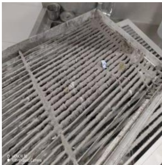
管道出风口清洗前
