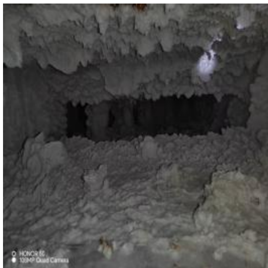
洗衣房管道清洗前
