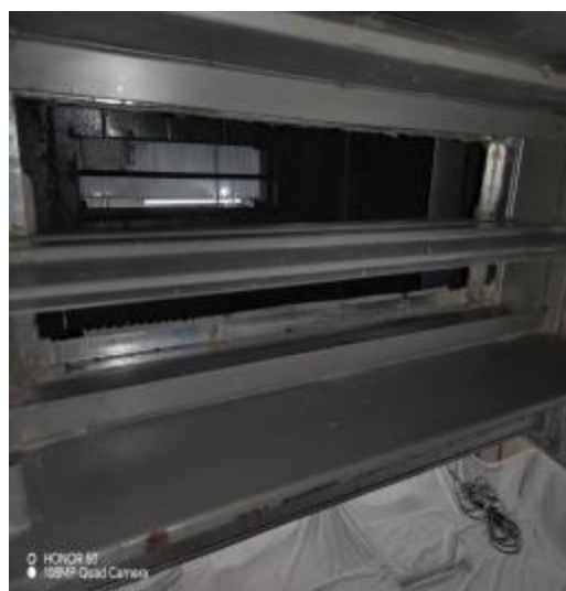
洗衣房管道清洗后
