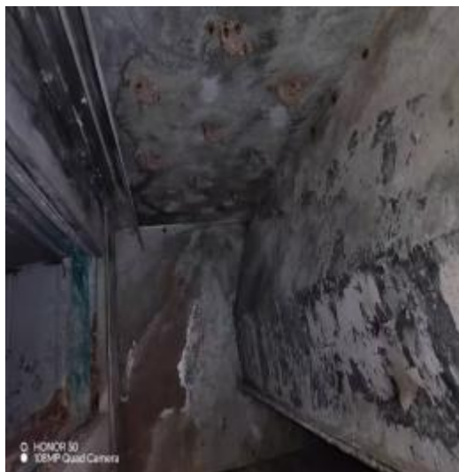
洗衣房管道清洗后
