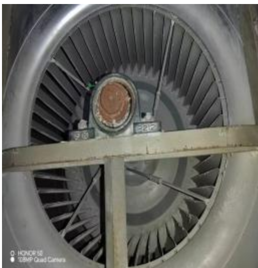
洗衣房风机清洗后
