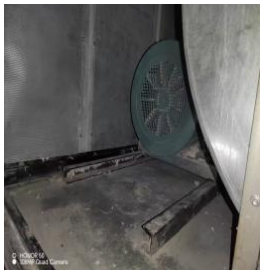
洗衣房风机清洗后
