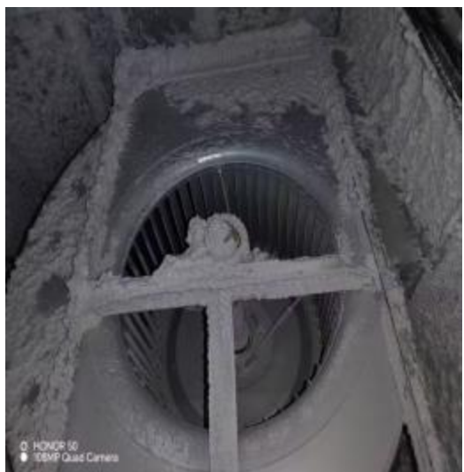
洗衣房风机清洗前
