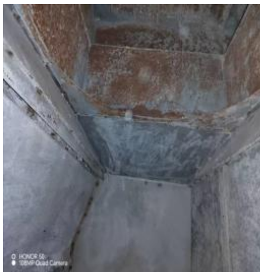
洗衣房管道清洗后
