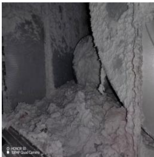
洗衣房风机清洗前
