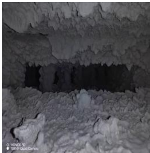
洗衣房管道清洗前
