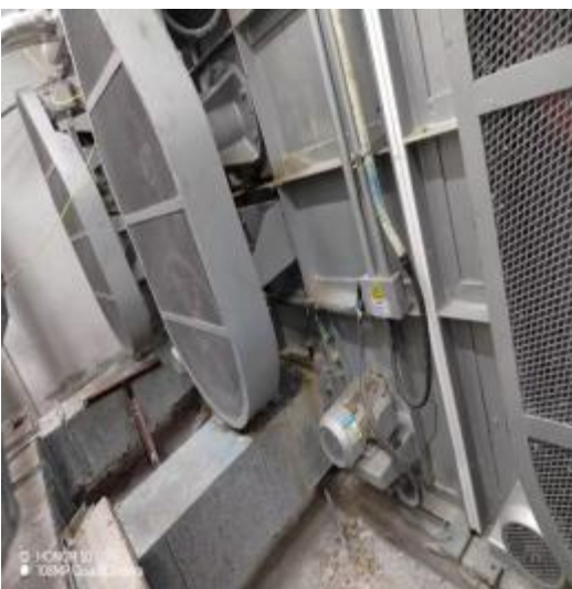
洗衣房风机清洗后
