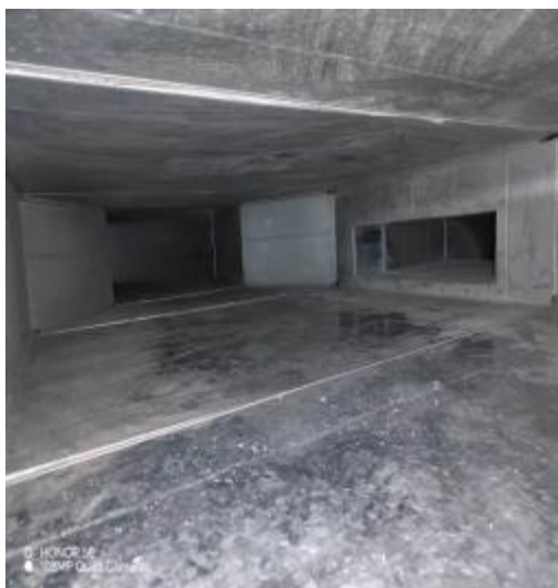
洗衣房管道清洗后
