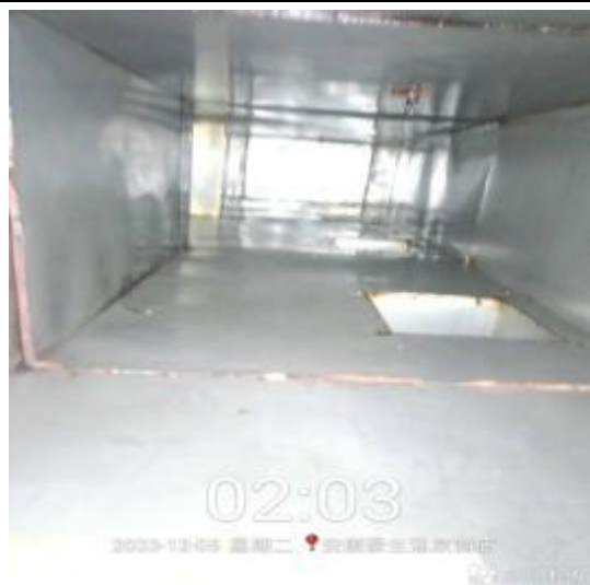
员工厨房管道清洗后
