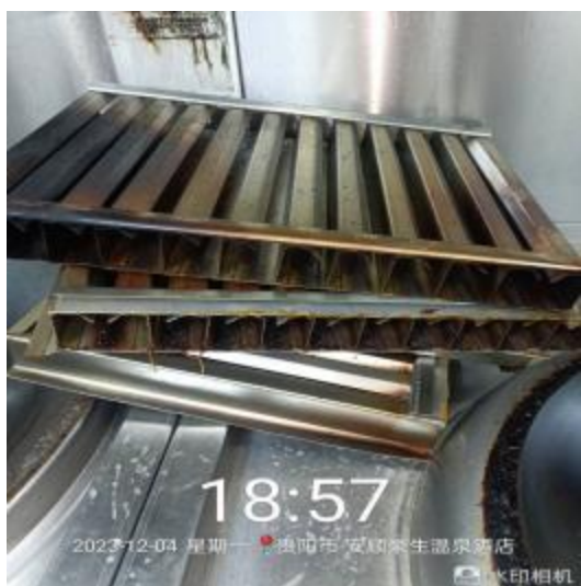
员工厨房防火板清洗前
