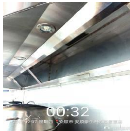
烧腊厨房烟罩清洗后
