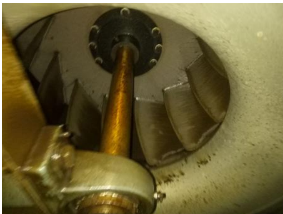
员工厨房风机清洗前
