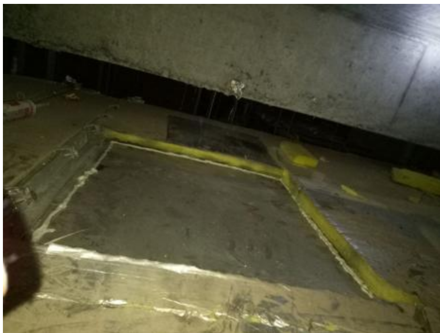
员工厨房出风口清洗前
