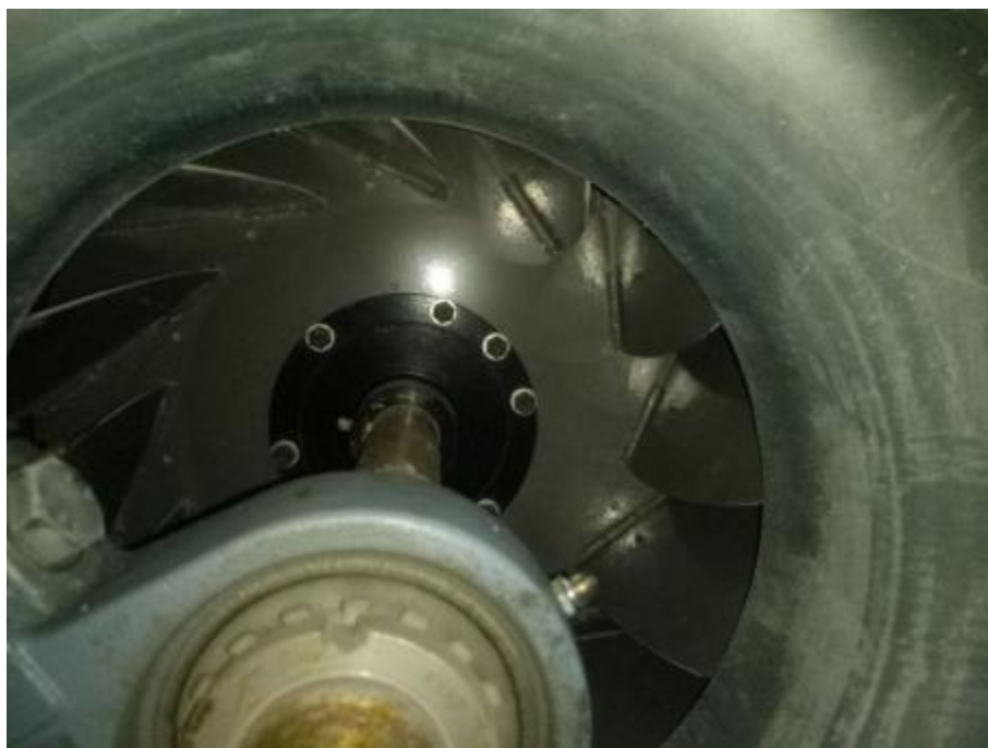
员工厨房风机清洗后
