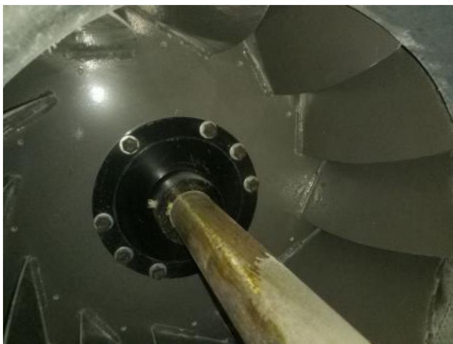
明档风机清洗后
