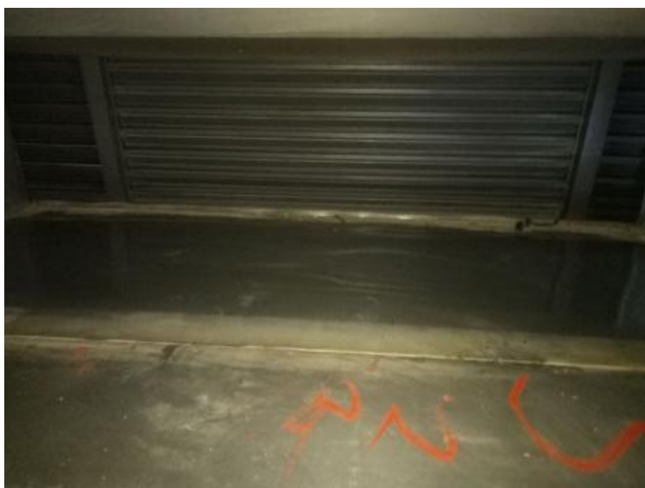
西厨房出风口清洗后
