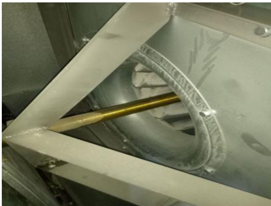
明档风机清洗前 3
