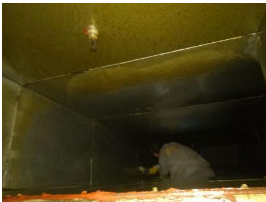
西厨房主管道清洗前
