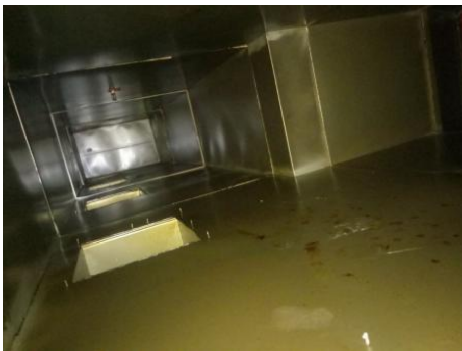
员工厨房主管道清洗前
