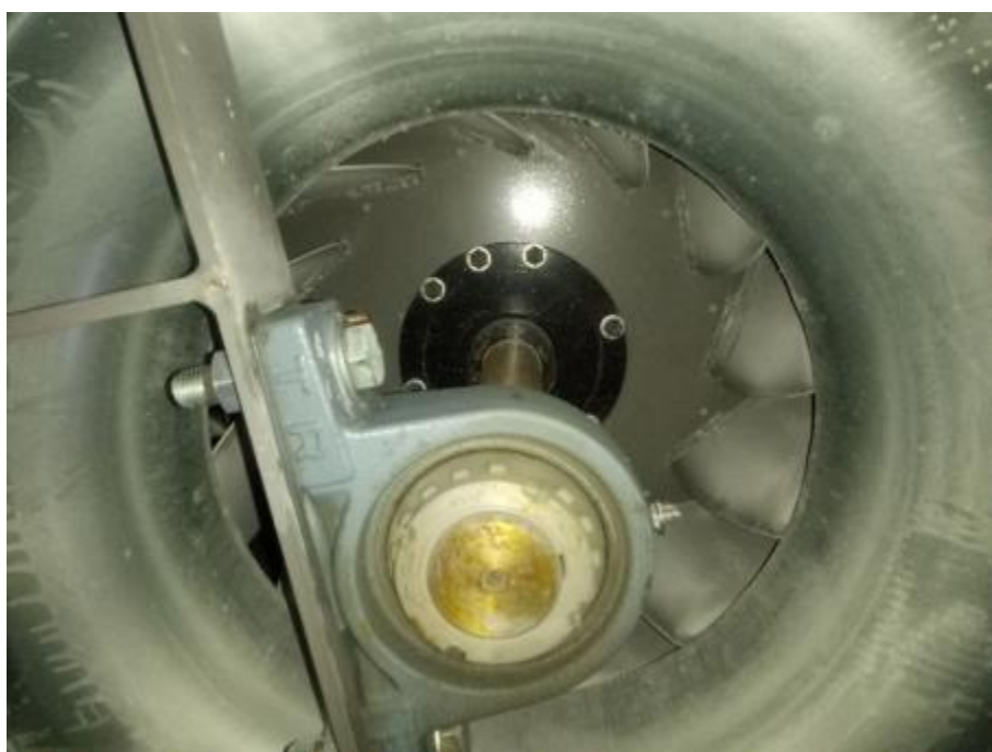
员工厨房风机清洗后
