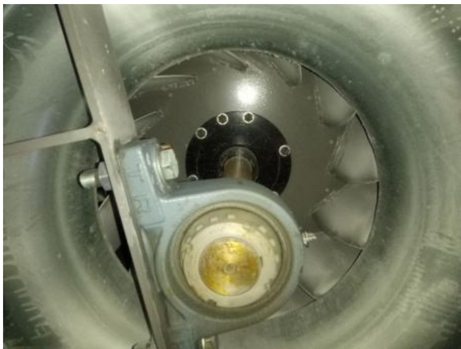
明档风机清洗后 3
