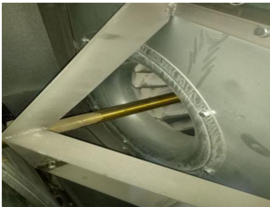
明档风机清洗前
