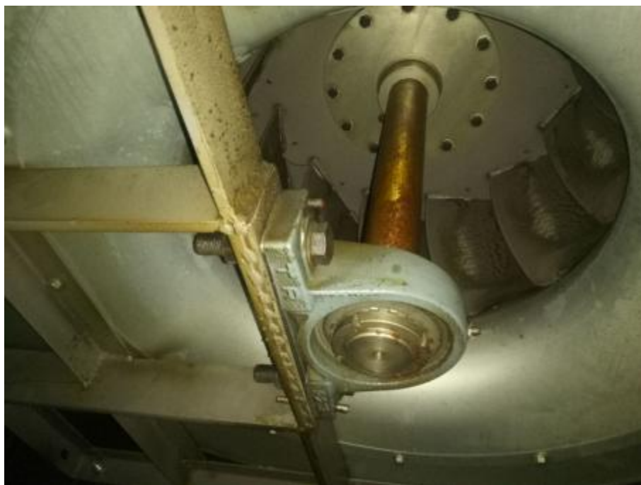
明档风机清洗前 1
