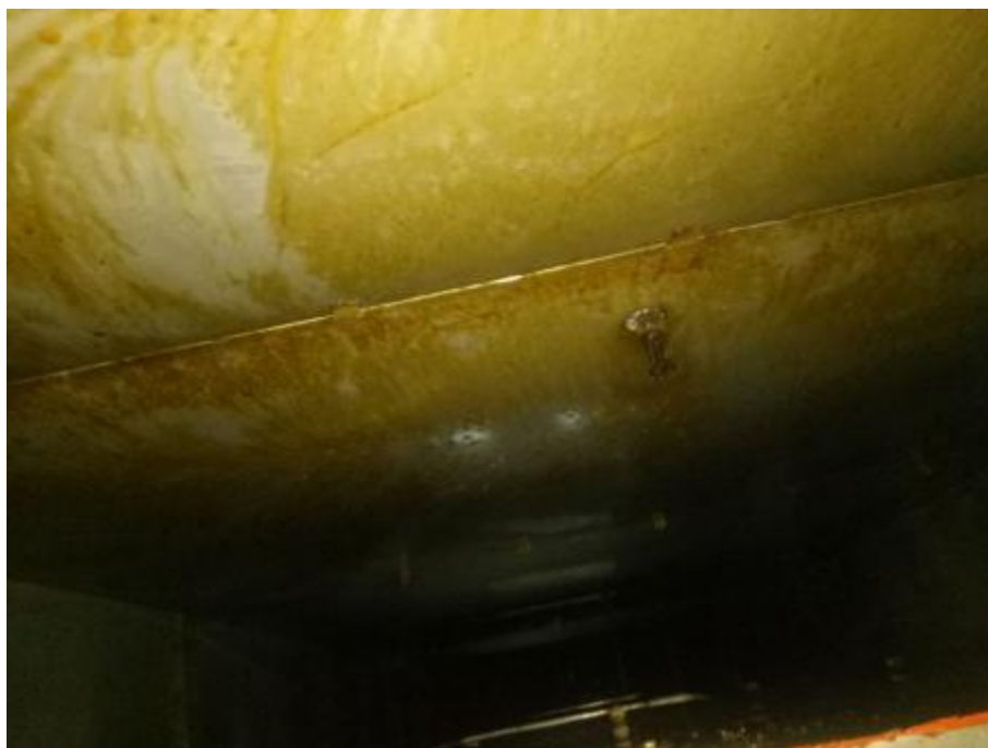
中厨房主管道清洗前
