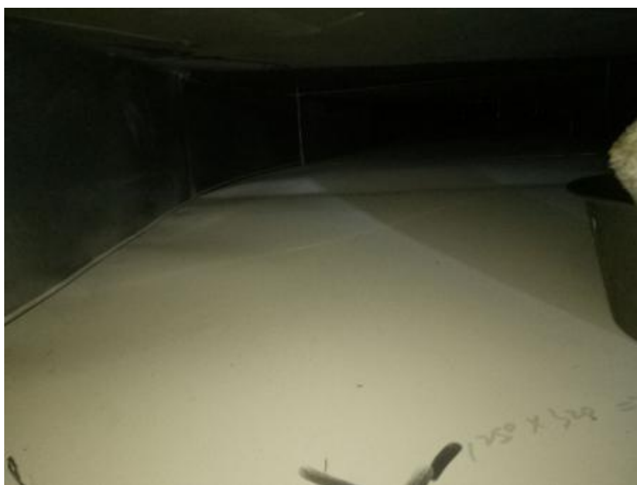
烧腊房出风口清洗前
