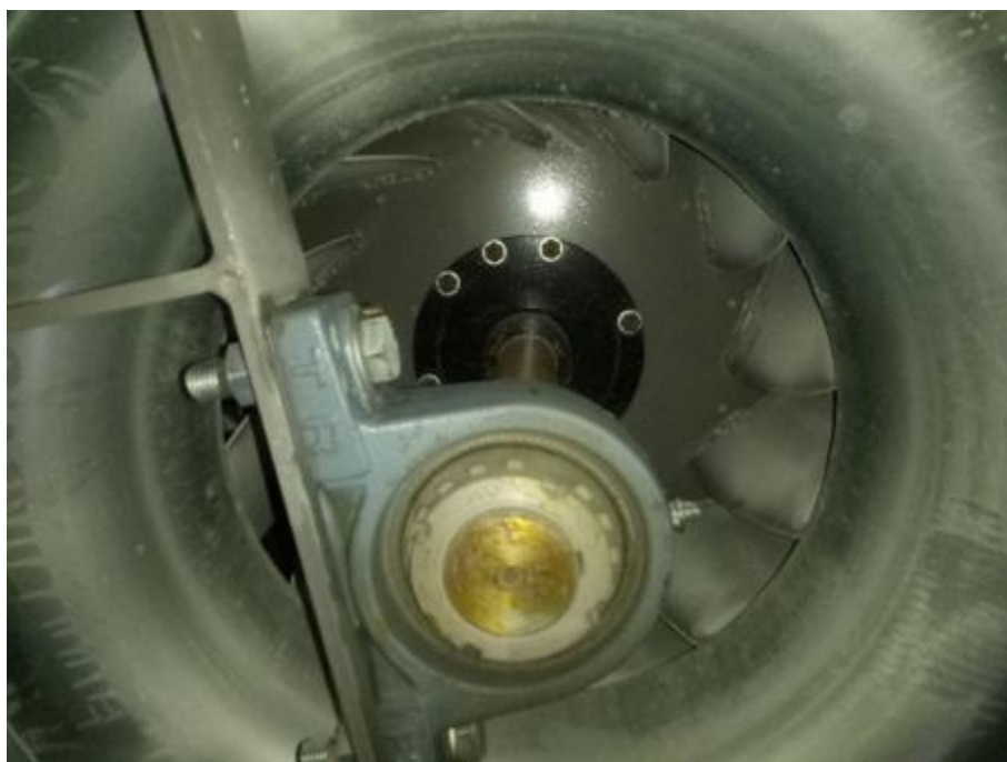
明档风机清洗后 1
