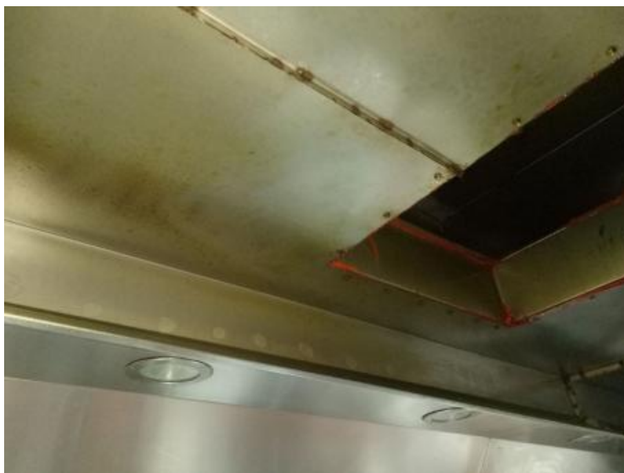
西厨房烟罩清洗前
