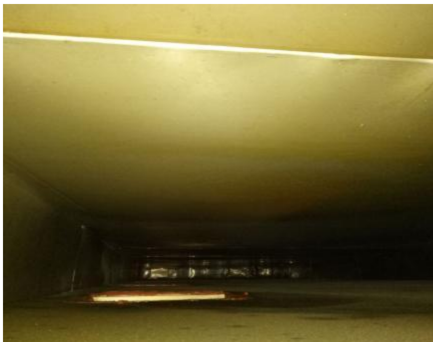
明档主管道清洗前
