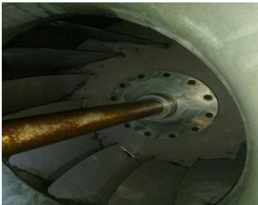
明档风机清洗前 2
