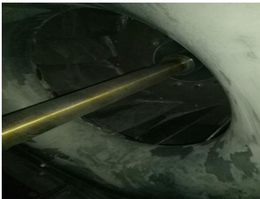
明档风机清洗后
