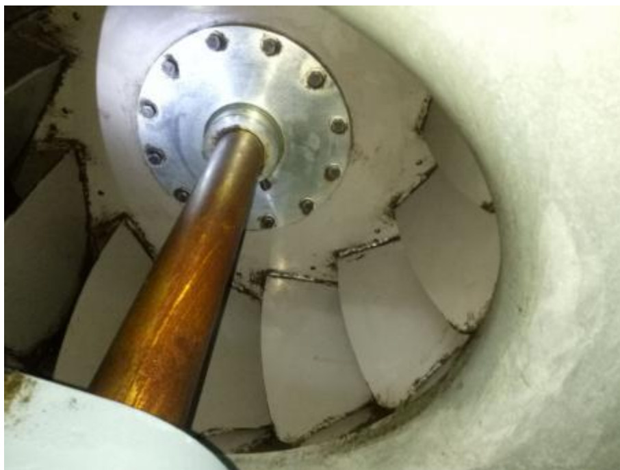
中厨房风机清洗后
