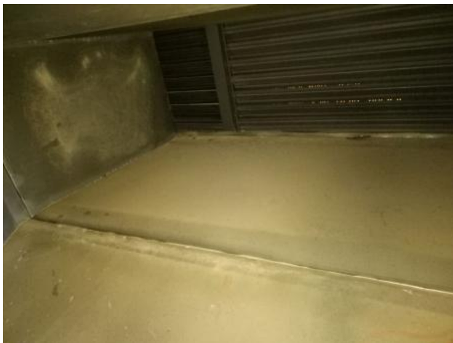
西厨房出风口清洗前
