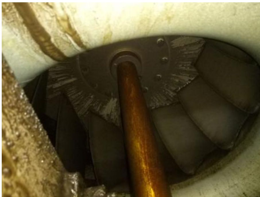
中厨房风机清洗前
