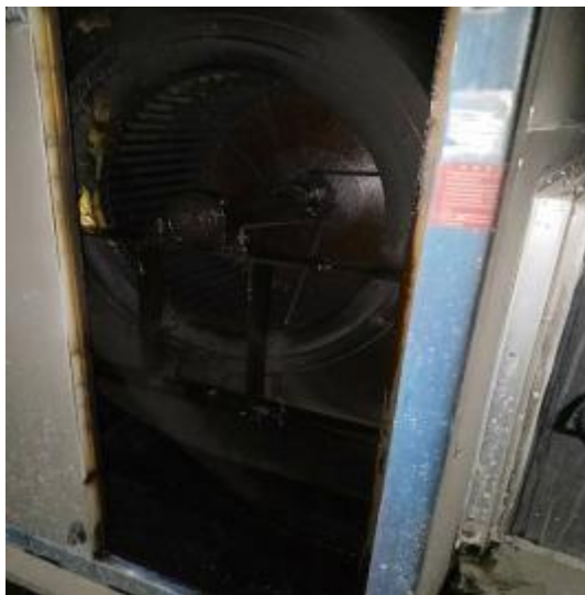
一楼风机清洗前 1
