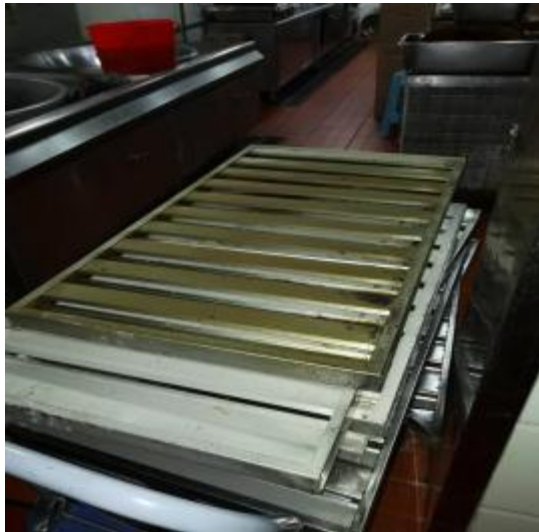
一楼风机清洗前
