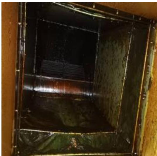
管道风机清洗前
