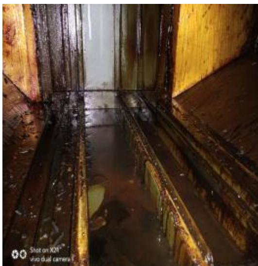
一楼净化器内部清洗前
