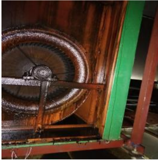
一楼风机清洗前
