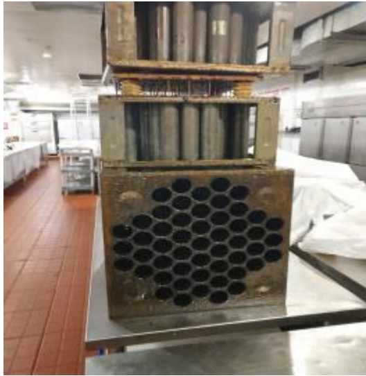
一楼净化器清洗前
