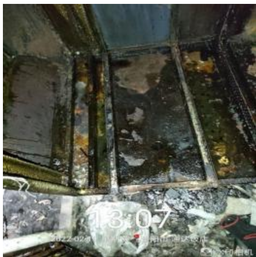
净化器机箱清洗前
